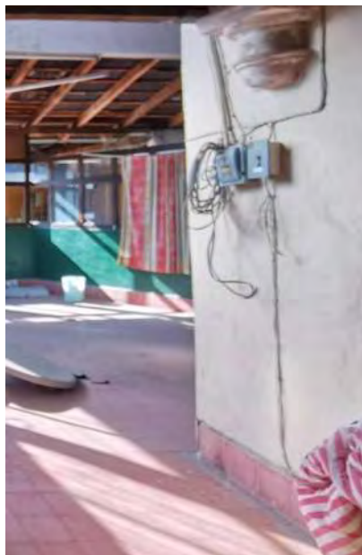
Figura 88: Centro de carga Fuente: Laura Monforte
