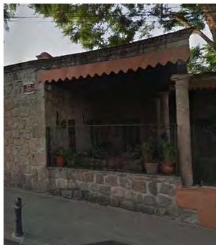
Figura 103: Lambrequín de lámina y barandal Fuente: Laura Monforte
