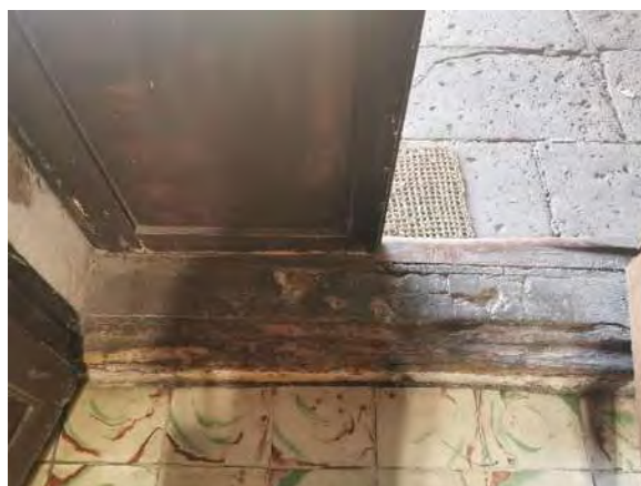
Figura 98: marco inferior de puerta Fuente: Laura Monforte
