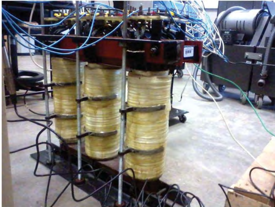
Figura 3.1 Transformador utilizado para validar el modelo
