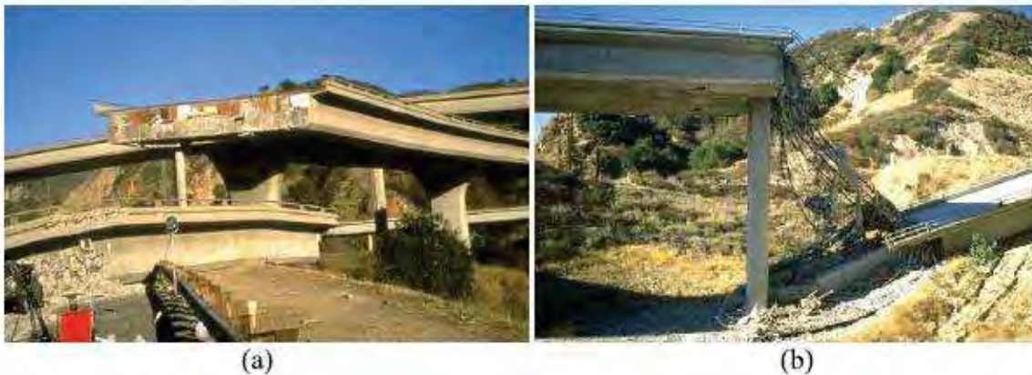
Figura 1.2.9. Pérdida de soporte debido al temblor de Northridge 1994 (a) Daños en puente existente (b) Daños en puente reforzado mediante cables de acero tradicionales. Tomada de Johnson et al. (2008).
