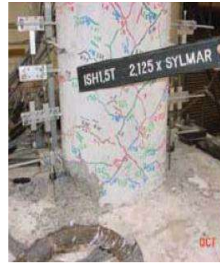
DS-4 Acero de refuerzo visible
