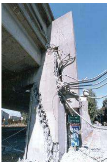
Falla por cortante
