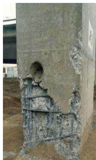
Deficiente longitud de desarrollo
