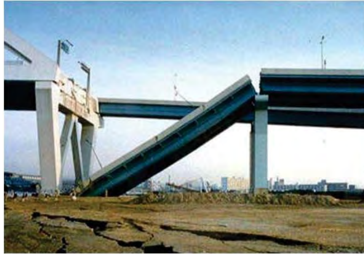
Figura 1.15 Daños en la vía rápida de Wangan por el sismo de Kobe (1995).
