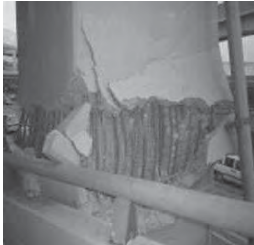
Figura 1.19 Falla en pila por traslapes y por confinamiento inadecuado, Puente Hanshin, Kobe 1995.
