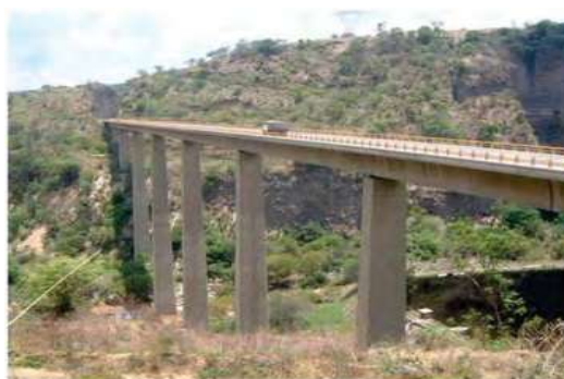
Figura 1.17 Puentes más recientes, soportados por pilas de una sola columna y con distribución irregular de rigidez, que los hace más vulnerables a acciones de tipo sísmico.
