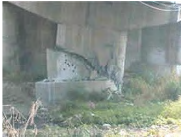
Figura 1.18 Falla en pila por cortante, Puente Wushi, Sismo de Taiwan 1999.
