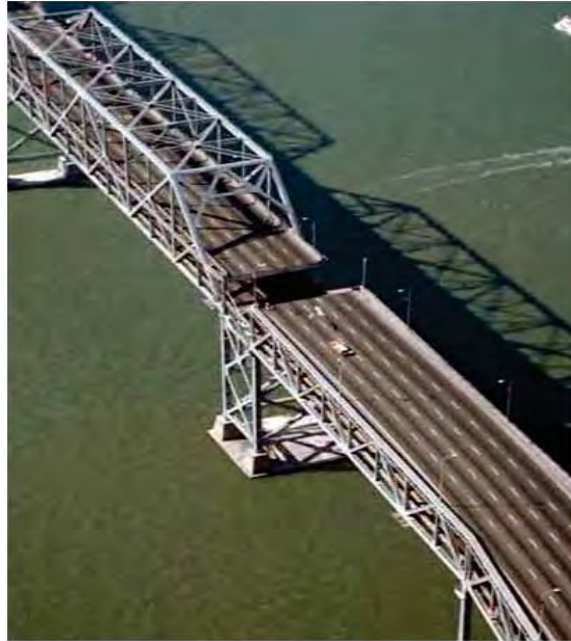
Figura 1.13 Derrumbe de calzada del puente de la Bahía de Oakland, San Francisco E.U.A. A causa del sismo de Loma Prieta (1989). ( http://ingenieriaenlared.files.wordpress.com/2007/06/bay_bridge_collapsed_aerial.jpg )
