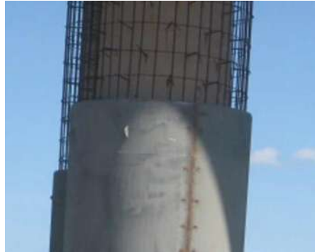
Figura I-5 Aplicación del encamisado a base de concreto y acero de refuerzo a una columna circular en el puente Hernando DeSoto en Tennessee. http://desroches.ce.gatech.edu/sites/default/files/pubs/seismicretrofit.pdf
