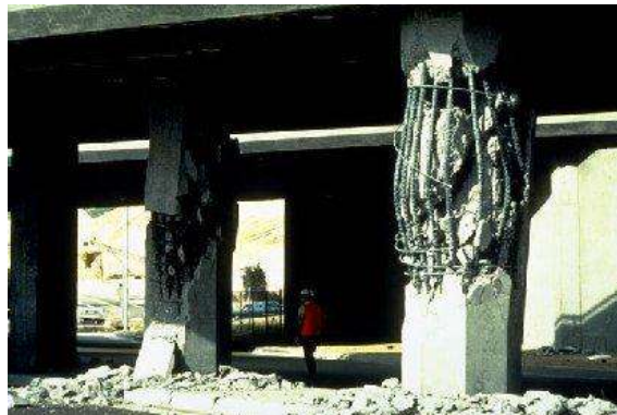
Figura I-3 Daño por cortante en las columnas de puentes debido al sismo de San Fernando en 1971. http://antonio-magallon.20fr.com/photo.html
