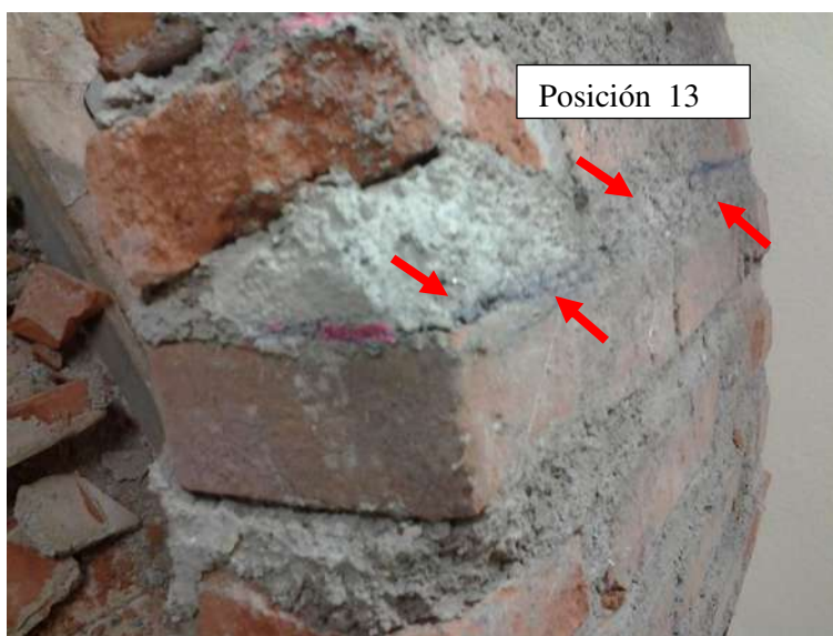
Figura 5.63. Zona del daño, Posición 13 de los sensores en la Figura 5.14.
