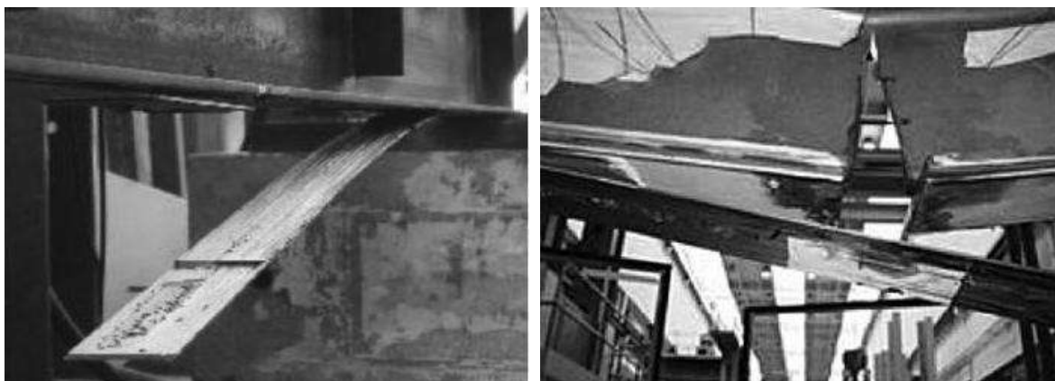
a) Desadherencia final
