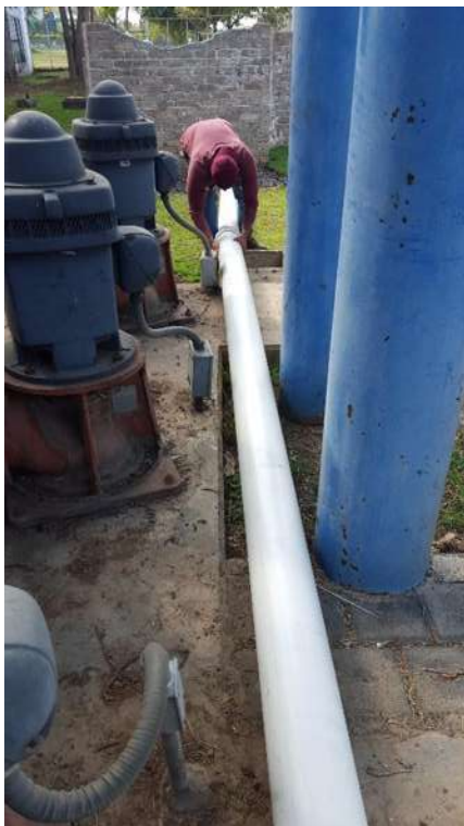
Figura 68.- Alineación y unión de la tubería en la línea de alimentación del modelo hidráulico.
