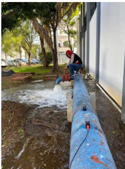
Figura 66.- Aforo de tubería del laboratorio de hidráulica.
