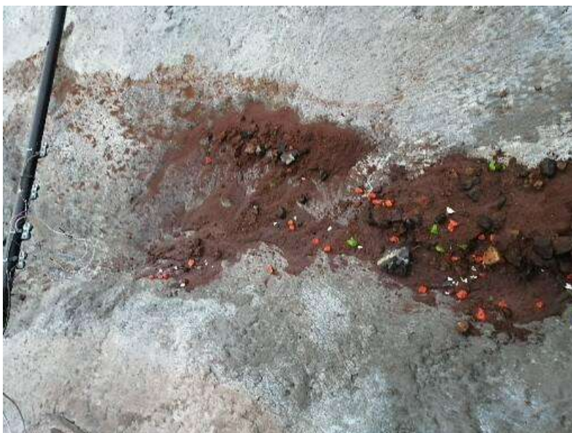
Figura 127. Depósito de agregados pétreos, debido a la disminución de capacidad erosiva en esa margen.
