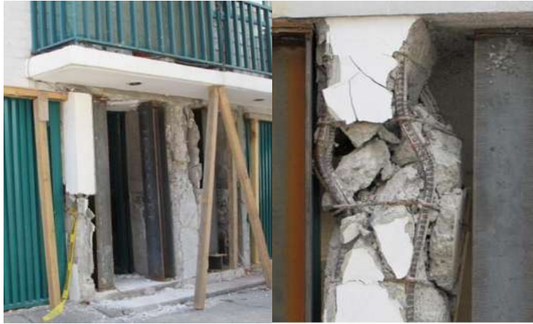
Figura 2.5 Columnas con falla a flexión-cortante (Fotos: Ruíz-García, 2017)
