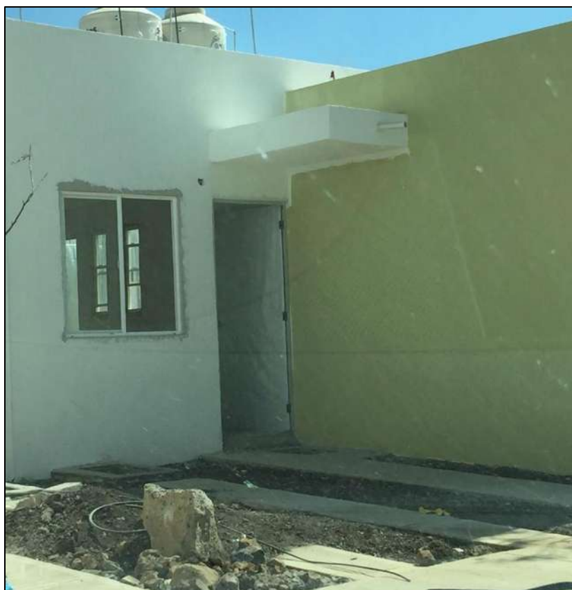
Figura 36.- Vivienda Deshabitada en el Fraccionamiento Villas del Pedregal, robo de aluminio.
