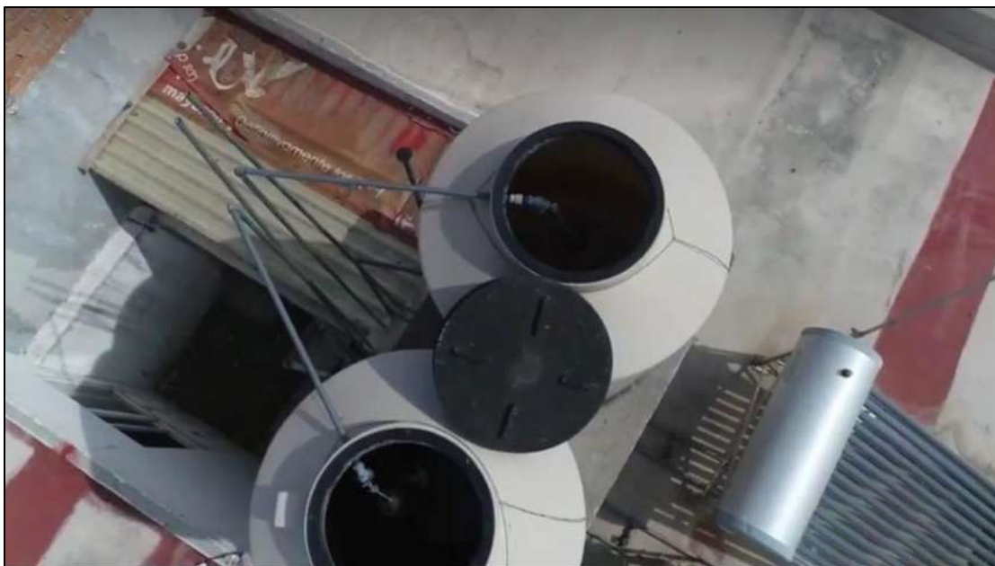
Figura 35.- Robo de tapaderas de tinacos en el Fraccionamiento Villas del Pedregal.
