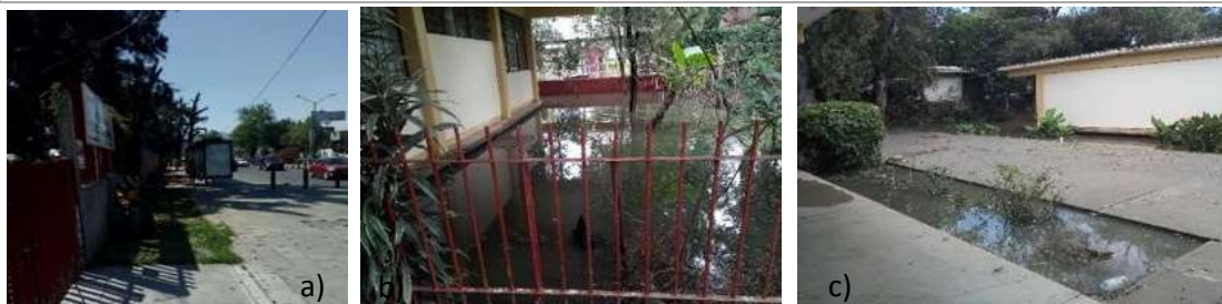
Figura 27. Planteles 2-PM2(PU) y 2-PV2(PU), a) Acceso principal sobre Calzada Juárez, b) Encharcamiento de jardín y c) Pasillos y jardineras
