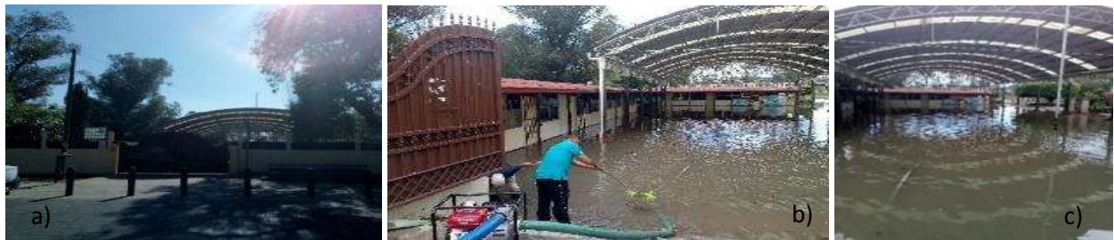
Figura 25. Planteles 2-PS(PU), 2-PM1(PU) y 2-PV1(PU), a) Acceso principal sobre Calzada Juárez, b) Extracción de agua en acceso principal ante inundación (22 octubre 2018) y c), vista de patio cívico ante evento de inundación (22 de octubre de 2018)
