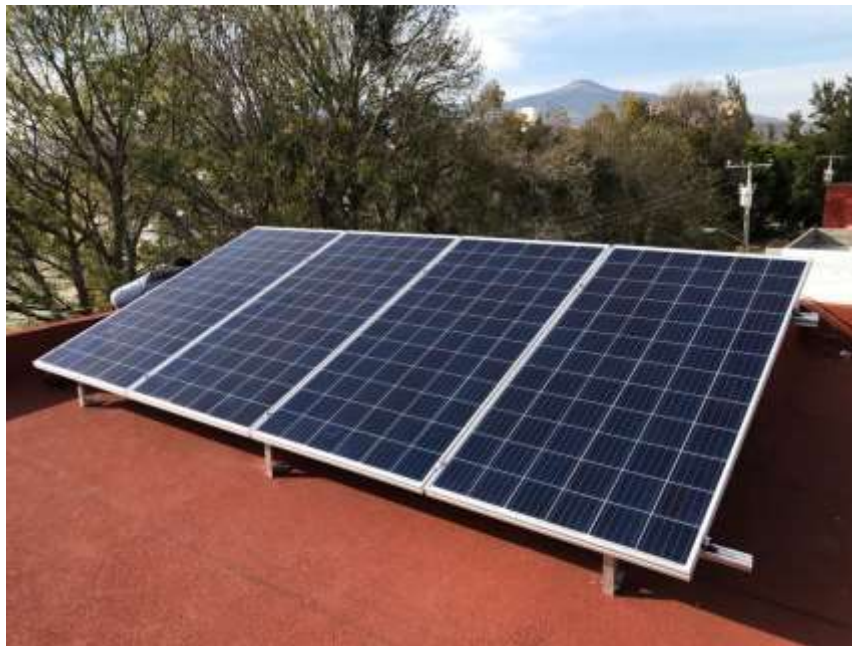
Figura 27. Instalación fotovoltaica de 1.34 Kw
