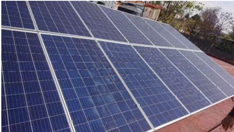
Figura 35. Instalación fotovoltaica de 4.48 Kw
