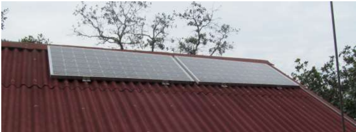
Figura 17. Instalación fotovoltaica de 390 W
