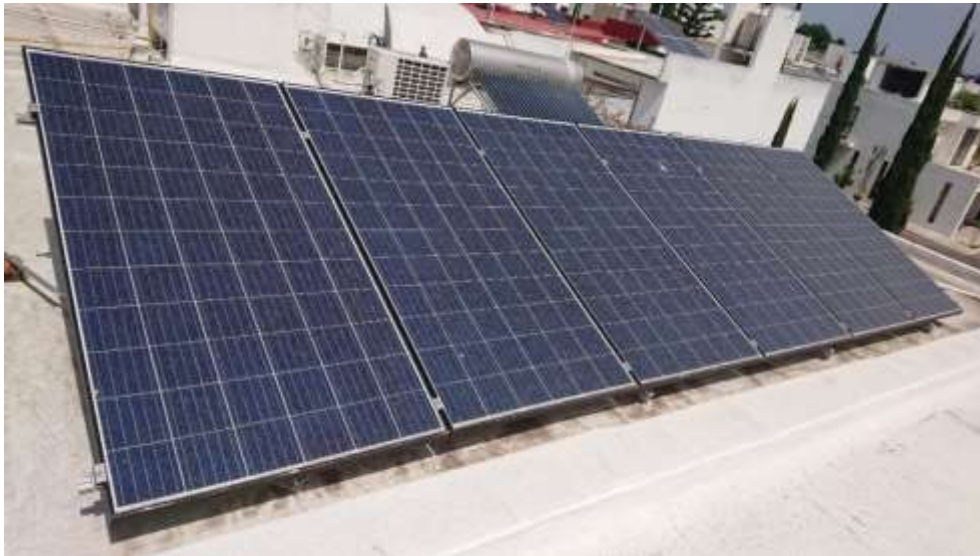
Figura 18. Instalación fotovoltaica de 1.92 Kw
