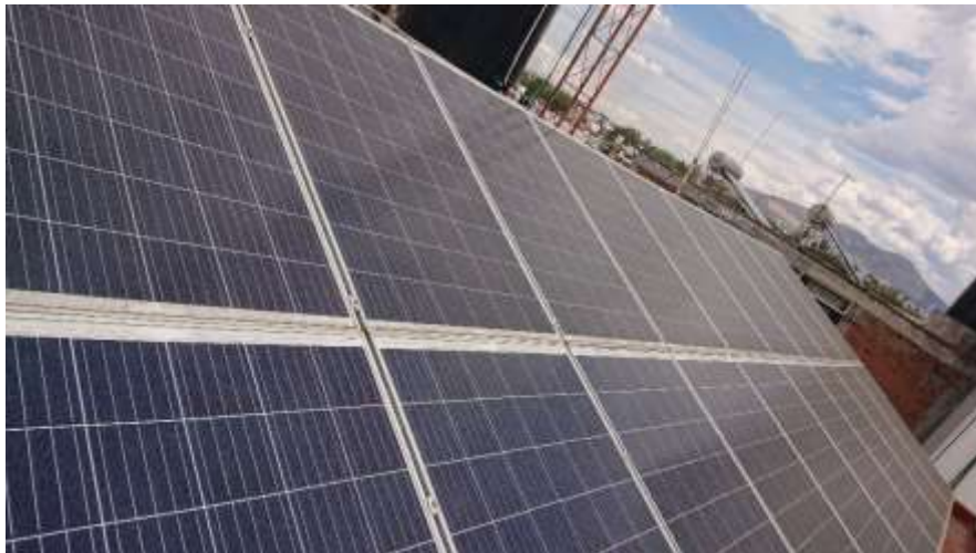
Figura 32. Instalación fotovoltaica de 4.86 Kw
