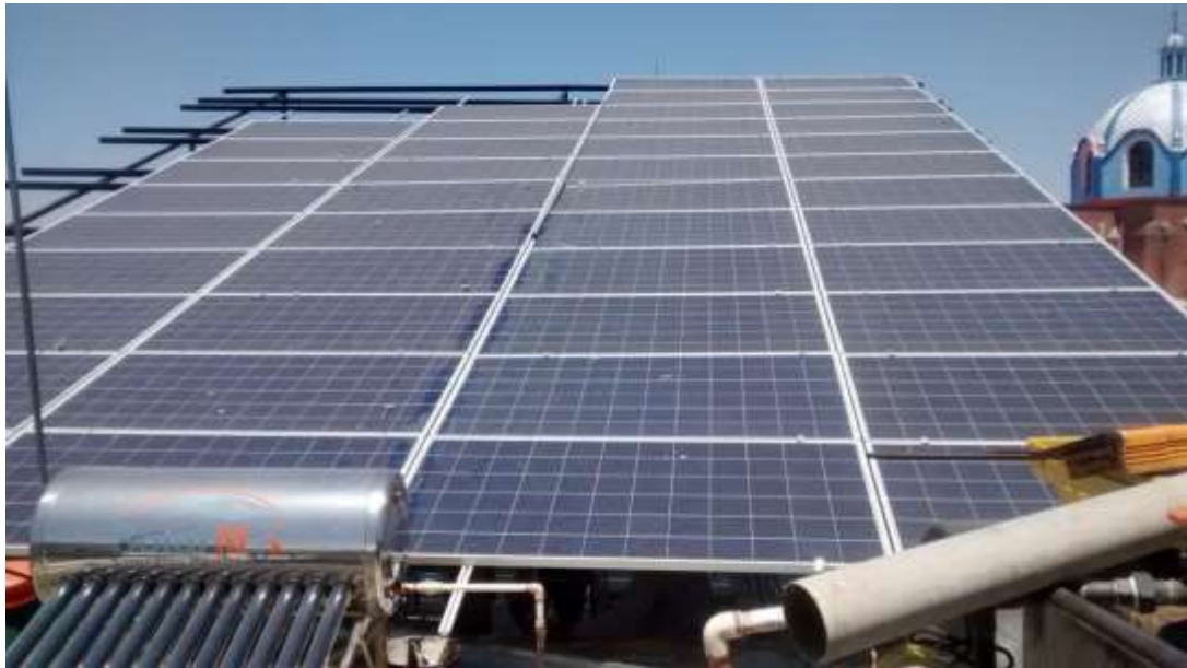
Figura 39. Instalación fotovoltaica de 12.87 Kw
