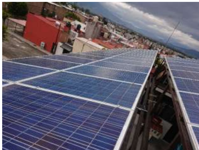
Figura 31. Instalación fotovoltaica de 12.750 Kw
