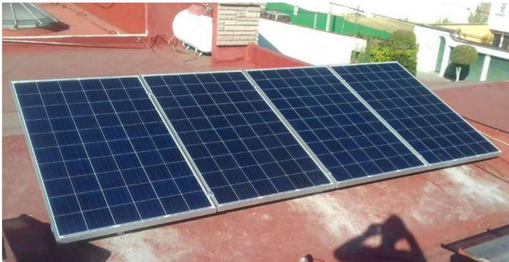
Figura 23. Instalación fotovoltaica de 1.04 Kw
