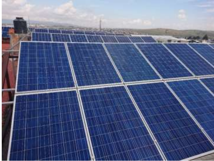
Figura 28. Instalación fotovoltaica de 20 Kw
