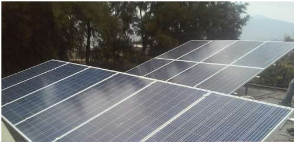
Figura 26. Instalación fotovoltaica de 4.48 Kw
