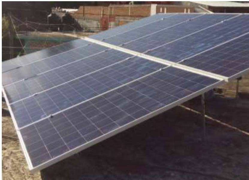
Figura 42. Instalación fotovoltaica de 3.3 Kw
