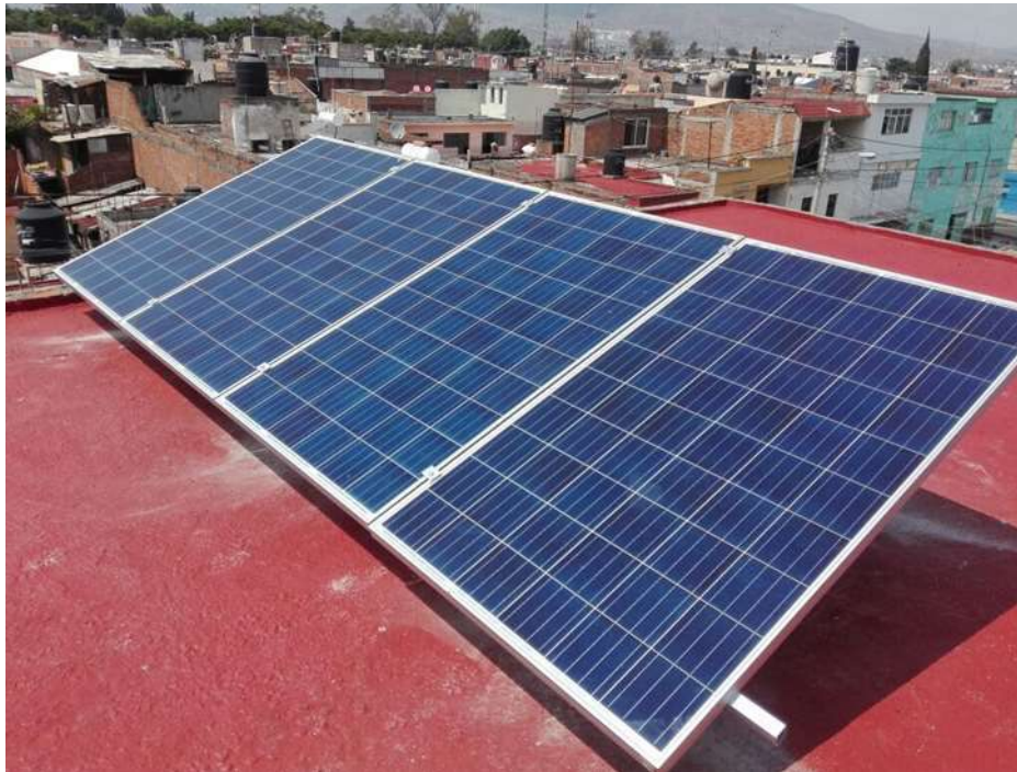
Figura 25. Instalación fotovoltaica de 1.04 Kw
