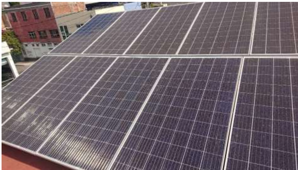
Figura 37. Instalación fotovoltaica de 3.30 Kw
