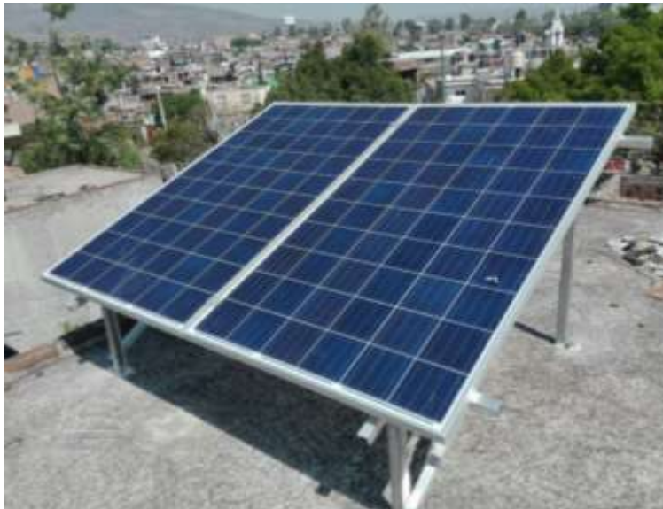
Figura 24. Instalación fotovoltaica de 520 W
