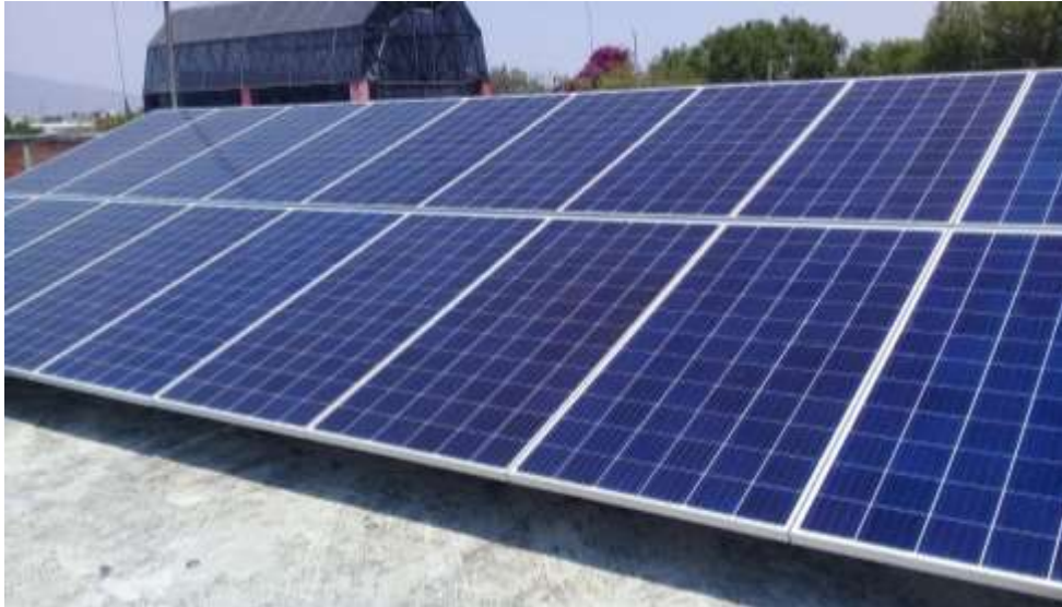
Figura 40. Instalación fotovoltaica de 5.94 Kw
