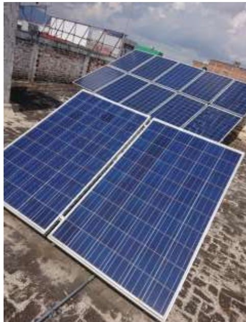
Figura 30. Instalación fotovoltaica de 7.750 Kw
