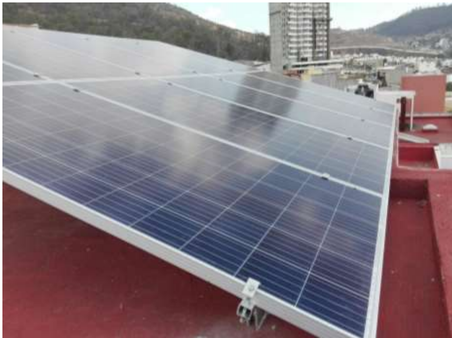
Figura 21. Instalación fotovoltaica de 3.2 Kw
