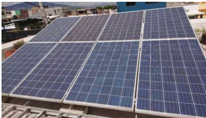
Figura 33. Instalación fotovoltaica de 2.0 Kw
