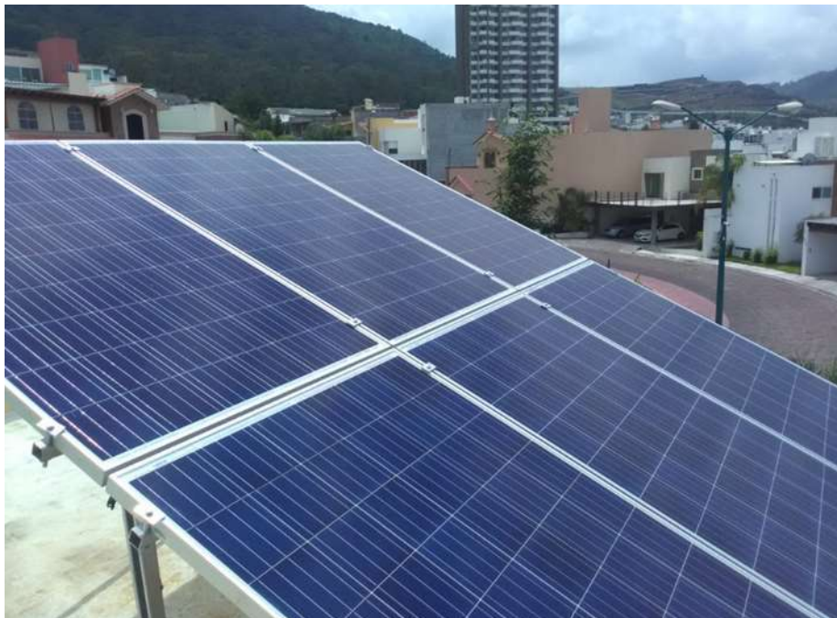
Figura 22. Instalación fotovoltaica de 1.56 Kw
