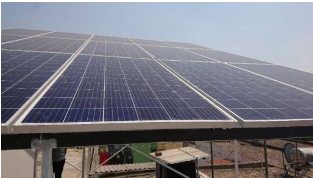
Figura 20. Instalación fotovoltaica de 5.94 Kw
