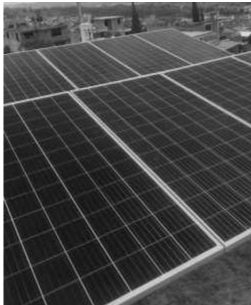
Figura 41. Instalación fotovoltaica de 3.96 Kw
