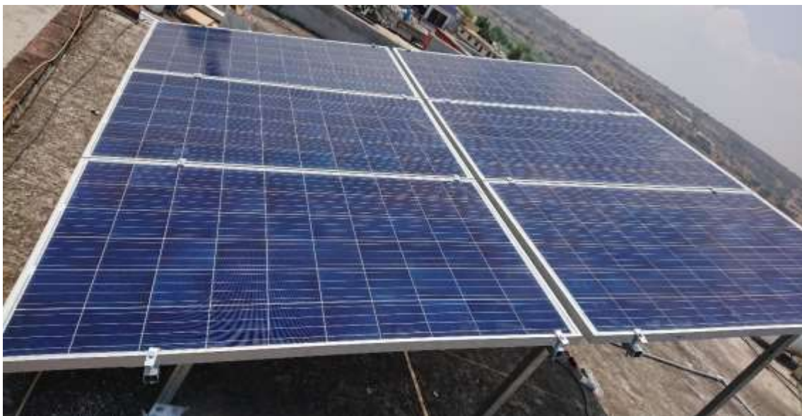
Figura 19. Instalación fotovoltaica de 1.56 Kw
