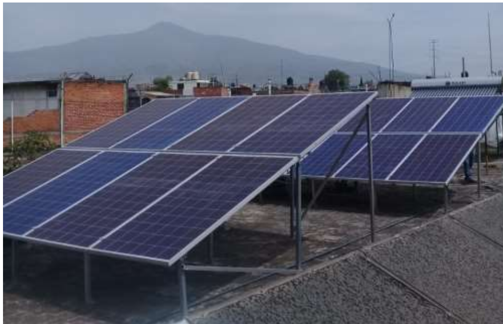
Figura 38. Instalación fotovoltaica de 5.44 Kw
