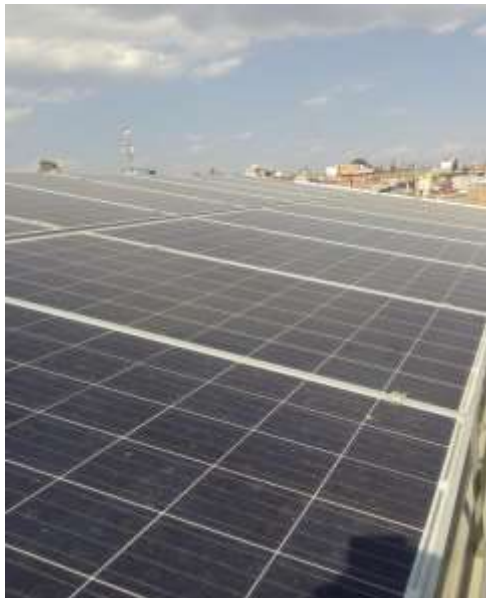
Figura 34. Instalación fotovoltaica de 10.0 Kw
