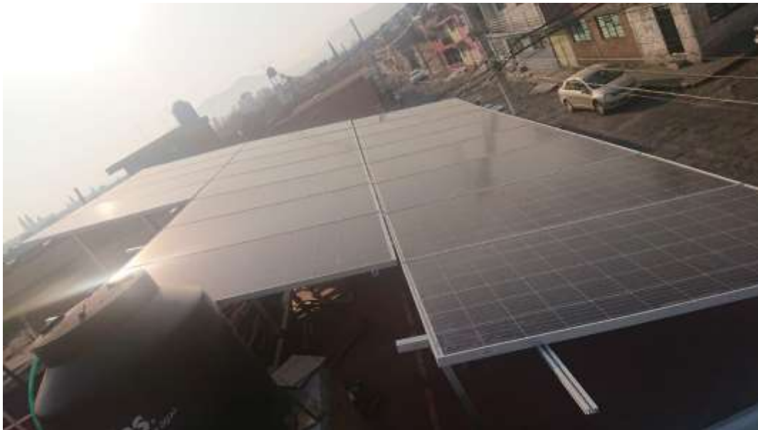
Figura 36. Instalación fotovoltaica de 6.27 Kw
