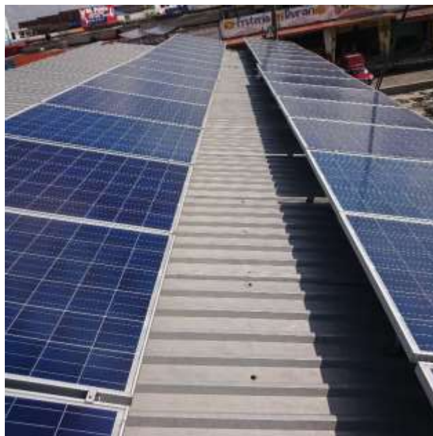
Figura 29. Instalación fotovoltaica de 8.25 Kw.
