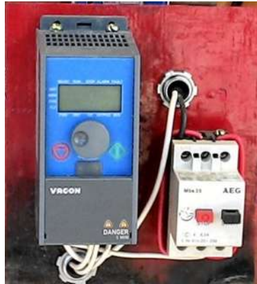
Figura 5.4 Variador de frecuencia.
