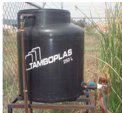
Deposito de PVC
