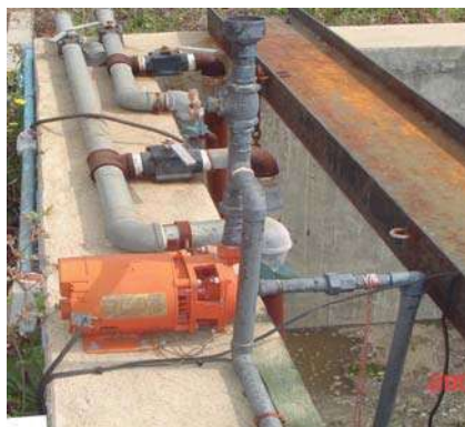
Sistema de bombeo
