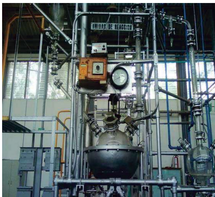
Figura 4.4 Sistema 2. Equipo de planta piloto manejado a condiciones atmosféricas con calentamiento constante.
