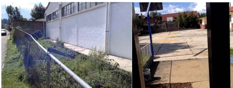
Figura 1.29 Sistemas de captación de agua de lluvia en la Escuela primaria Lázaro Cárdenas de Ahuiran, Paracho, Mich., Fuente: Foto tomada por CRS.
