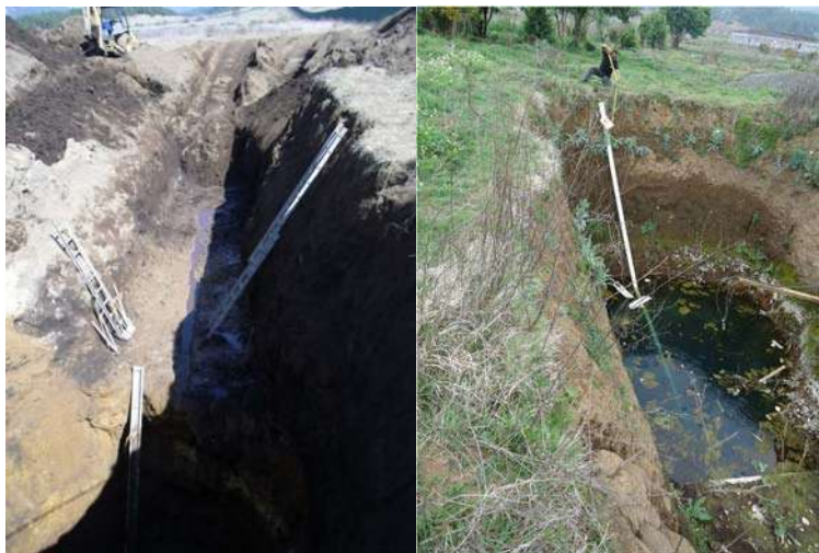
Figura IX. Perforación de la noria, se ubica dentro del campus Universitario. El aforo fue de 2 lts/segundo. Fuente: Foto tomada por CRS.
