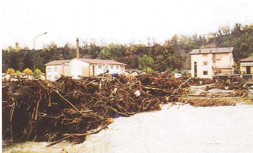
Figura III.8.- Puente de Ceva obstruido por troncos y basura flotante (parte Alta del Valle Tanaro).
