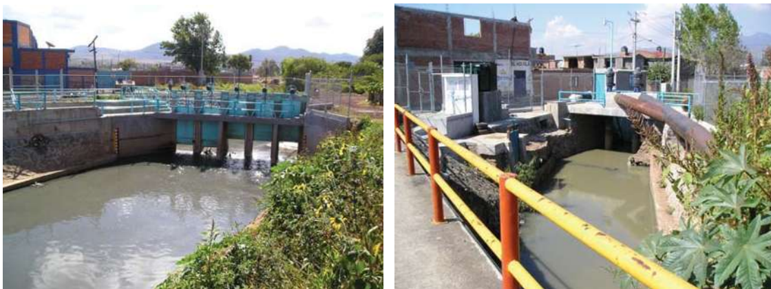
Figura IV.19.- Cárcamos de bombeo que se localizan sobre el río Grande.
