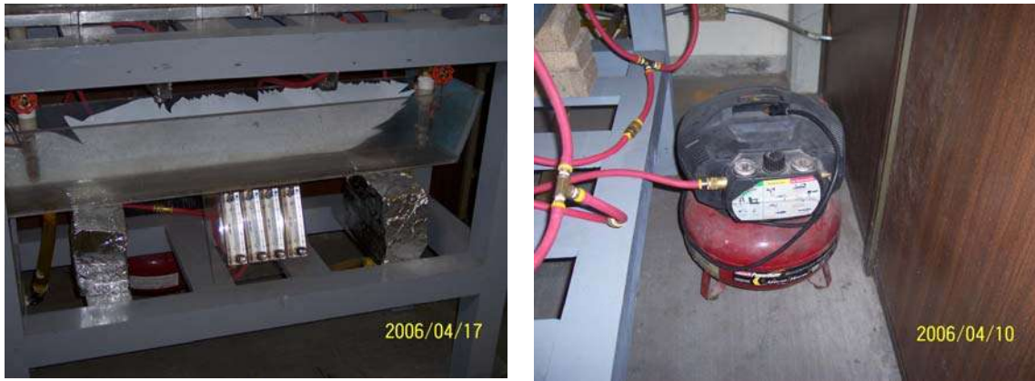
Figura 3.50, Vista de los medidores de flujo y compresor de aire
