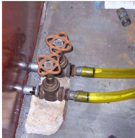
Figura 3.41, Válvulas de alimentación al recipiente metálico
