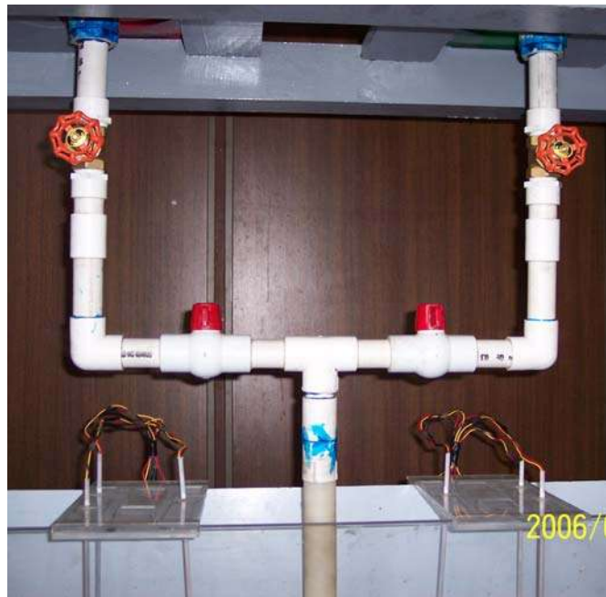
Figura 3.31, Válvulas de alimentación
