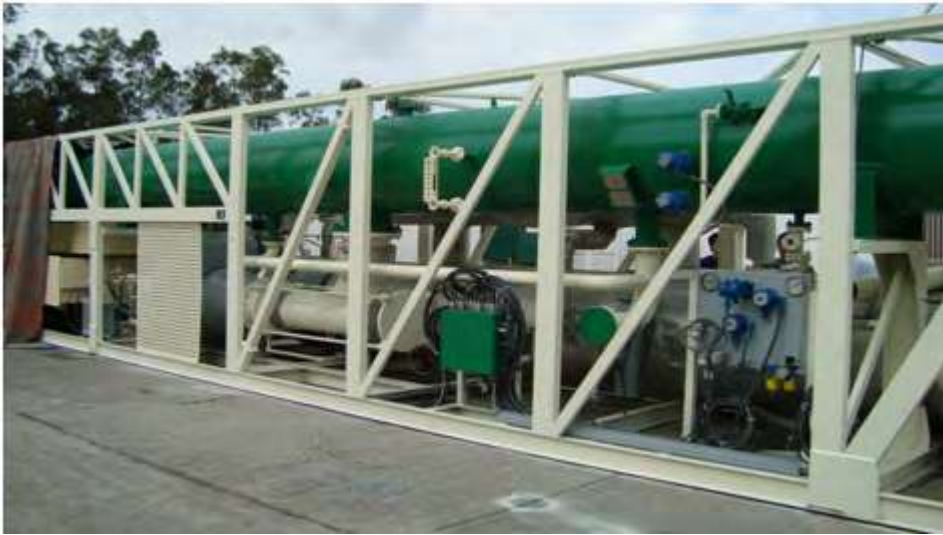
Figura 3.3: Planta ORMAT de 300 kW instalada en el campo geotérmico de Simirao Michoacán.
