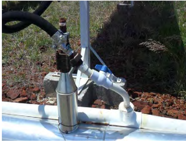
Figura 59. Deformación de las conexiones de descarga de la segunda línea de los colectores parabólicos
