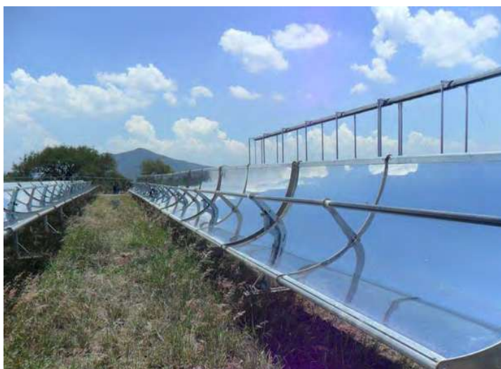
Figura 10. Concentradores cilindro parabólico
