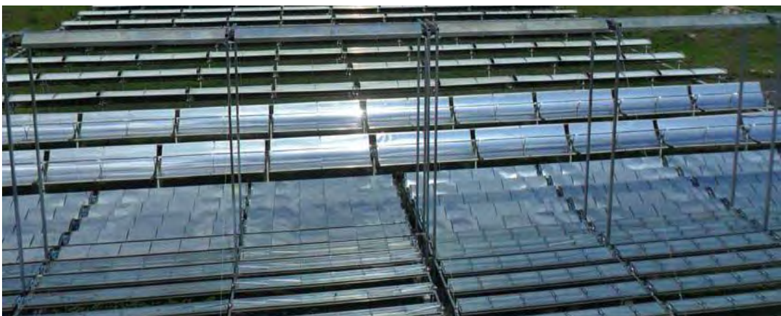
Figura 68. Colectores parabólicos en funcionamiento II
