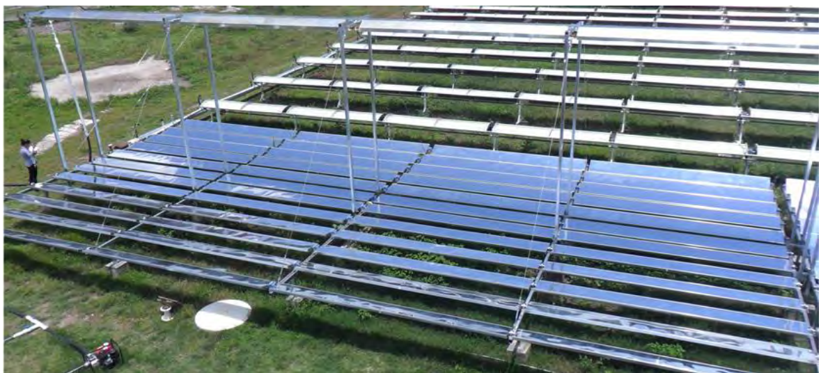
Figura 69. Colectores fresnel en funcionamiento
