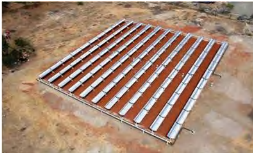
Figura 33. Campo de colectores cilindro parabólicos
