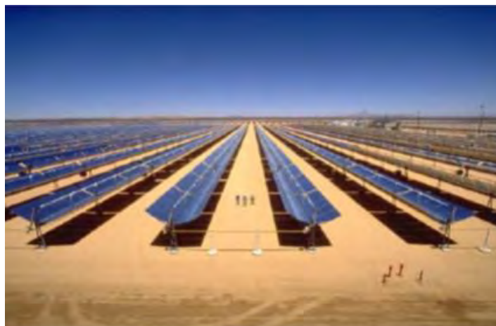
Figura 19. Colectores de la planta SEGS
