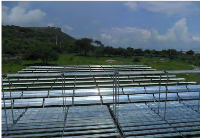
Figura 15. Campo de colectores fresnel
