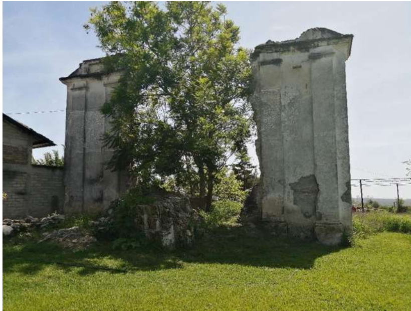
Figura 53: Estado actual de los vestigios de la fachada de la ermita de la Finca San Vicente Enaltik, Comitán.
