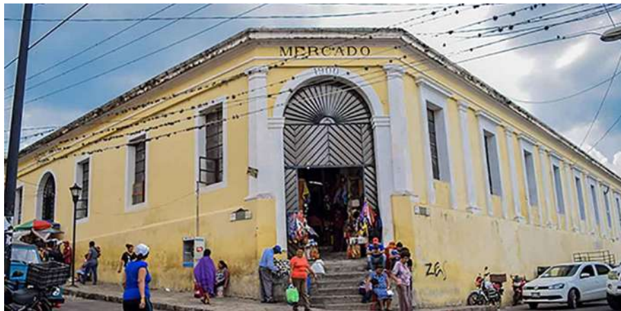
Figura 69: Estado actual del Mercado Municipal de Comitán, Chiapas. Fuente: Revista Primer Plano
