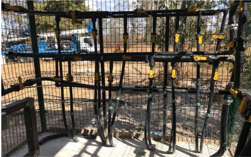
Figura 16. Conexiones de entrada y salida de los intercambiadores de calor verticales.
