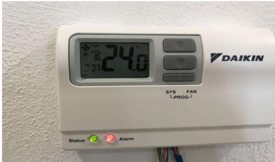
Figura 17. Condiciones de operación del termostato.
