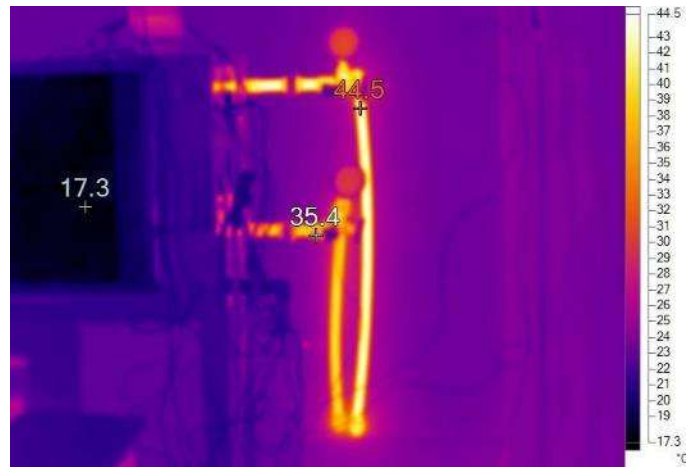
Figura 19. Entra y salida del fluido de trabajo de los intercambiadores de calor a la bomba de calor.
