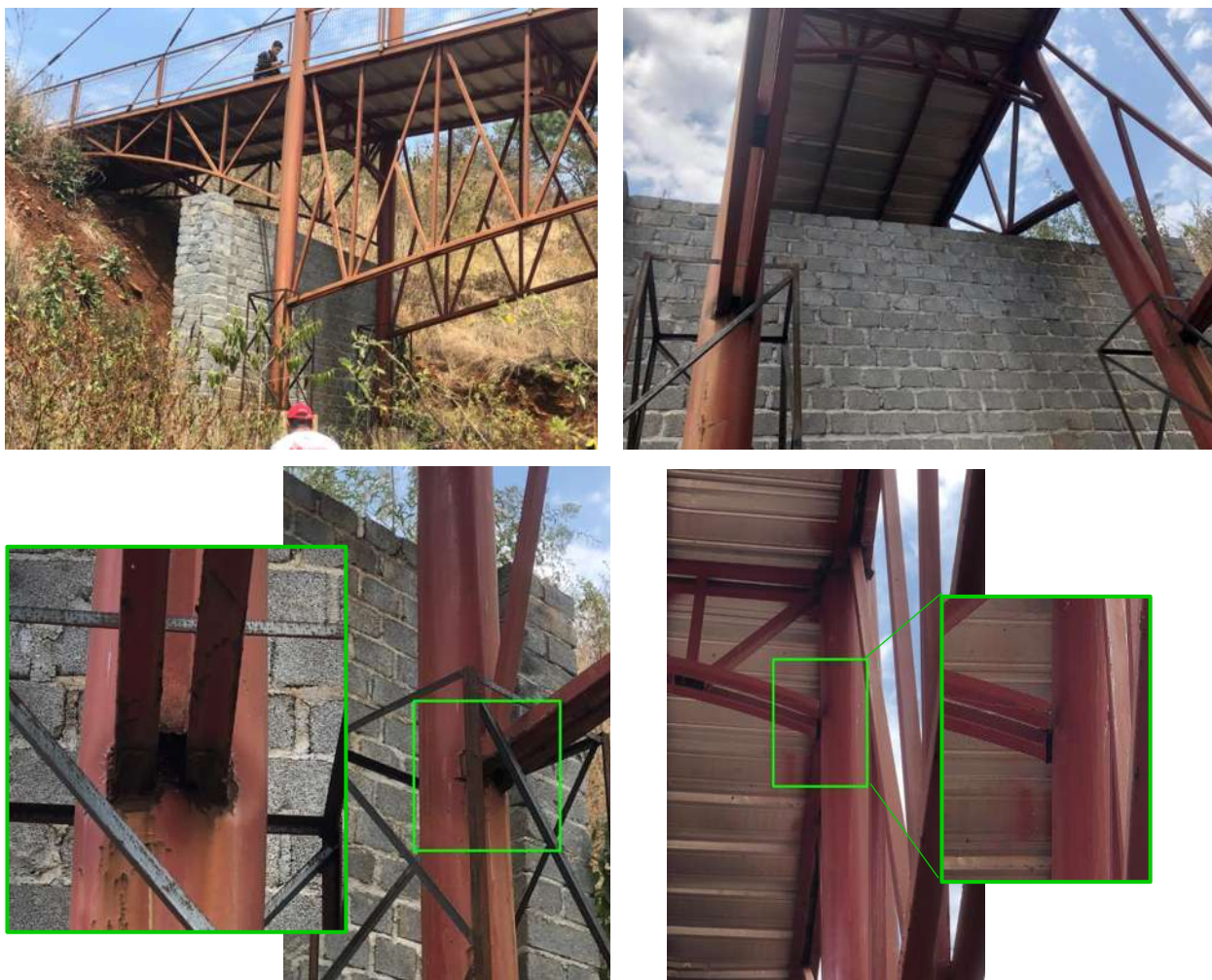
Figura 6.5 Detalle de columnas, punzonamiento de cuerdas en columnas, defectos en soldadura.
