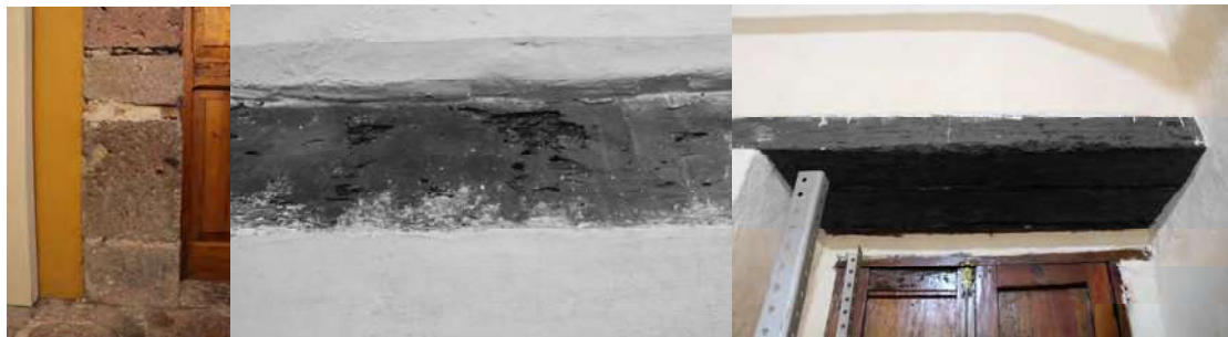
Fig. 155 Vano enmarcado con platabanda dovelada en donde se identifica exfoliación de la junta que ha sido rellenada con cemento y está generando incompatibilidad de materiales generado por un factor antrópico. En la segunda y tercera imagen se observan efectos de organismos inferiores sobre los cerramientos de madera de algunos vanos. Fuente: Fotografía tomada por RGM & METR 2021
