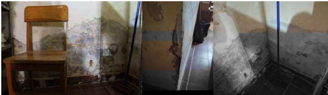
Fig. 151 Disgregación de aplanados, pinturas y sillares por humedad proveniente desde la cimentación. Fuente: Fotografía tomada por RGM & METR
