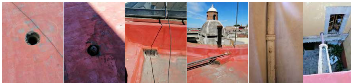
Fig. 120 Bajadas de agua pluvial en azotea, tubería expuesta y bajada pluvial por medio de una gárgola hacia un patio interior que ha sido cancelada en la última restauración en 1993. Fotografía: METR
