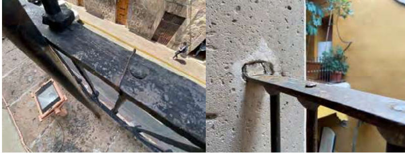
Fig. 156 En la primera imagen se pueden observar manchas y desgaste en las capas de pintura de esmalte que cubre algunas partes de la herrería, causadas por excrementos de organismos superiores y en la segunda imagen se puede observar incompatibilidad de unión de materiales de hierro con cantera. Fuente: Fotografía tomada por RGM & METR 2021
