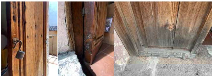
Fig. 157 Algunas puertas tienen presencia de insectos y otras han sufrido efectos como la pérdida de esmalte por el contacto con la humedad. En las puertas y ventanas existen texturas que se marcan como vetas sobresaltadas por la deshidratación en la carpintería debido al constante contacto directo con los rayos solares. Fuente: Fotografía tomada por RGM & METR 2021
