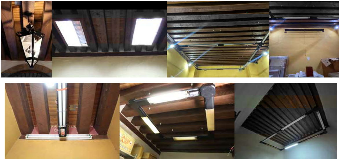
Fig.117 Instalaciones eléctricas de iluminación en distintos espacios al interior de la CAMEM. Fotografía: METR
