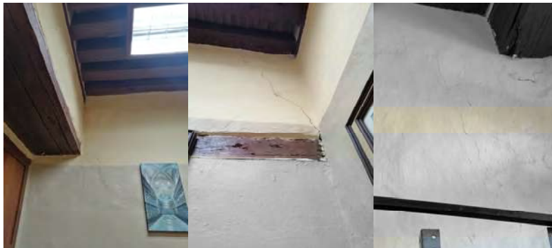
Fig.130 Registro fotográfico agrietamiento en los muros perpendiculares al macroelemento fachada en el área de consulta y la biblioteca de la CAMEM. Elaboró: METR
