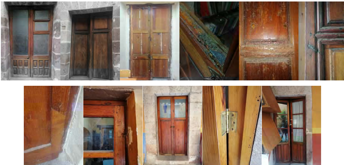
Fig. 123 Arriba, elementos de carpintería presumiblemente más antigua debido a manufactura y estado de conservación, abajo elementos de carpintería renovados o sustituidos. Fotografía: METR
