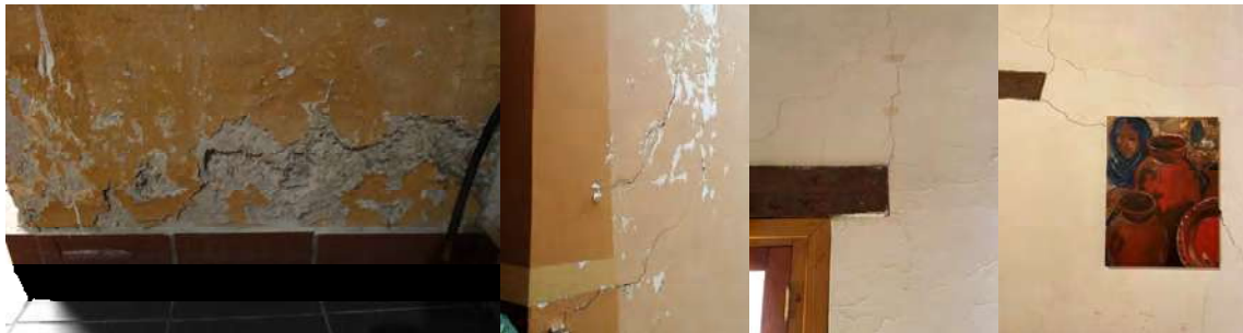
Fig. 153 Humedades por capilaridad con desprendimiento de aplanados, fisuras en los muros de la planta alta, fisuras que nacen en el dintel de algunos vanos. Fuente: Fotografía tomada por RGM & METR 2021
