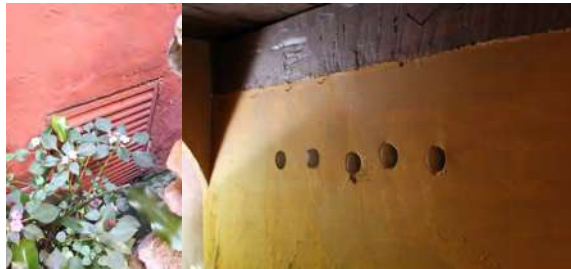
Fig.122 Respiraderos de una red de drenaje de aireación en los muros perimetrales en la CAMEM. Fotografía: METR
