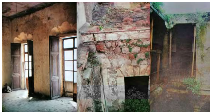
Fig. 146 Fotografías del estado de abandono de la CAMEM antes de la intervención de la intervención en 1993. Fuente: Vargas Jaime, el monumento que volvió a nacer
