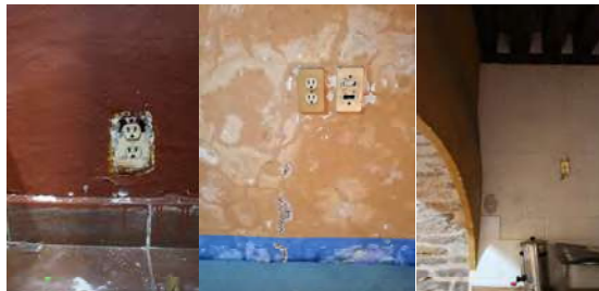
Fig.118 Instalaciones eléctricas contactos y apagadores en distintos espacios al interior de la CAMEM. Fotografía: METR
