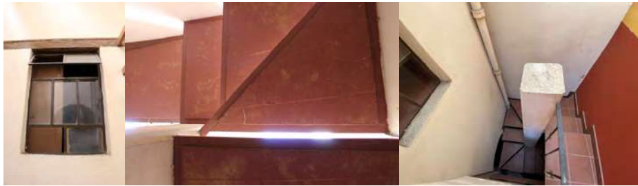
Fig. 127 Registro fotográfico de ventanas sencillas y escalera de servicio, en donde se considera herrería sencilla y de poco valor artístico. Fotografía: RGM & METR
