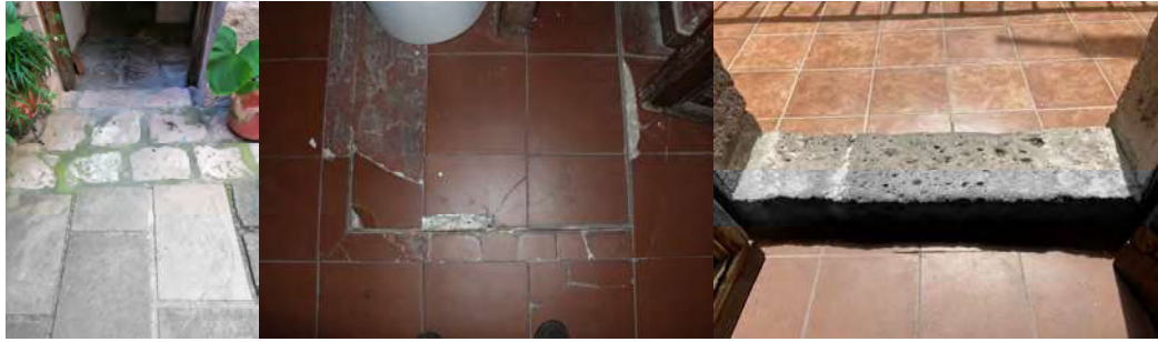
Fig. 152 Intemperismo en pisos exteriores, mosaico de pasta de cemento quebrado en planta baja y juntas erosionadas en la planta alta. Fuente: Fotografía tomada por RGM & METR
