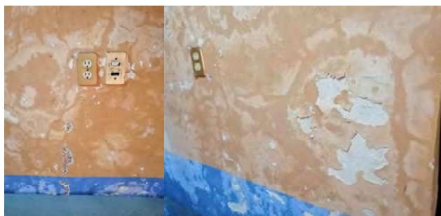
Fig. 158 Contactos y apagadores en la planta baja en donde la humedad ascendente por capilaridad y las sales solubles los han dañado. Fuente: Fotografía tomada por RGM & METR 2021
