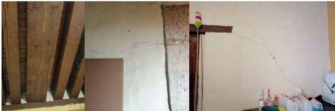
Fig. 132 Registro fotográfico de cubierta en el vestíbulo, así como de bodega de usos múltiples y oficinas administrativas en planta alta (Arriba del centro del vestíbulo) donde se observa agrietamiento en el muro CAMEM. Elaboró: METR
