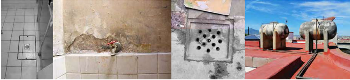
Fig. 119 Registro sanitario en baños posteriores, llave de nariz en séptico de cocina, coladera de cantera en segundo patio y tinacos de asbesto en azotea con instalación de cobre de 3/4". Fotografía: METR
