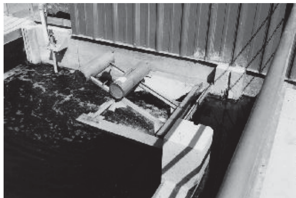
Figura 2.10. Vista lateral de una compuerta Amil para el control de Tratamiento de Aguas Residuales.
