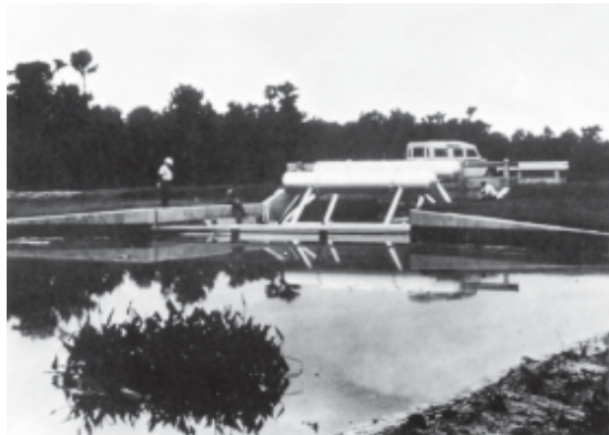
Figura 2.9. Vista posterior de una compuerta Amil y control de nivel aguas arriba.
