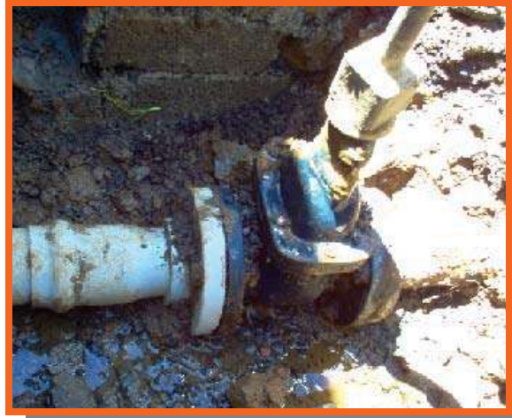
Válvula de seccionamiento de 3" del tanque de menores dimensiones
