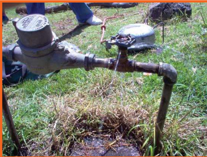
Medidor CICASA existente en la mayoría de las tomas que cuentan con el; ningún micro medidor funciona.
