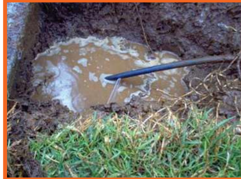
FUGA EN MANGUERA
