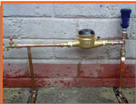
MICROMEDIDOR CON VÁLVULA EXPULSORA DE AIRE INSTALADO EN EL D.H
