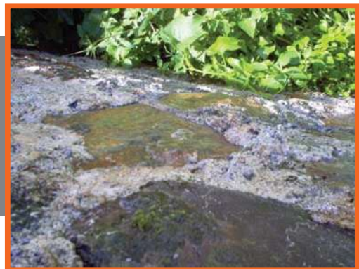
Vista de la fuga desde la parte alta del tanque; fuga abundante que simula una cascada
