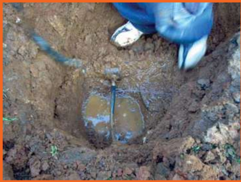
FUGA EN MANGUERA
