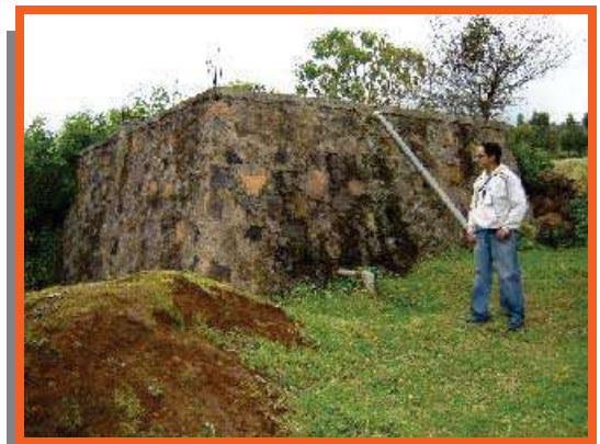
Tanque de la colonia Fraccionamiento Fresnos
