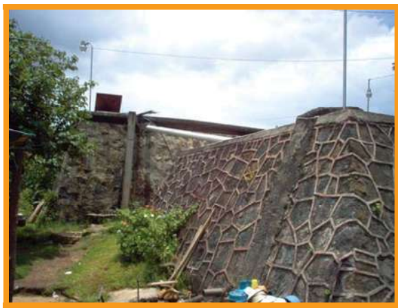
Tanques del Calvario vista 1
