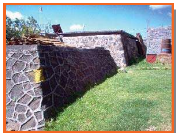
Tanques del Calvario vista 2
