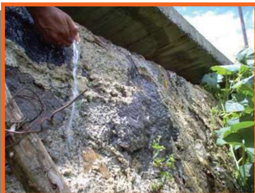
FUGAS EN TANQUES
