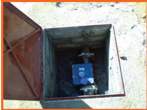
MACRO MEDIDOR INSTALADO
