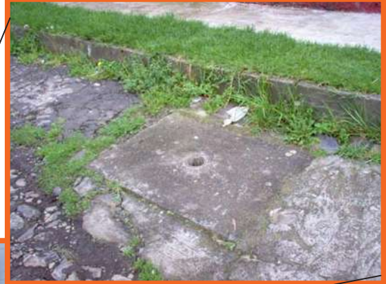
Válvula limite ubicada en la calle Kungurikua y Jarajkukata de la colonia Erendira 1
