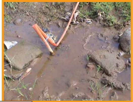
Situación de las tomas en los predios baldíos, una de las principales causas de fugas de agua potable
