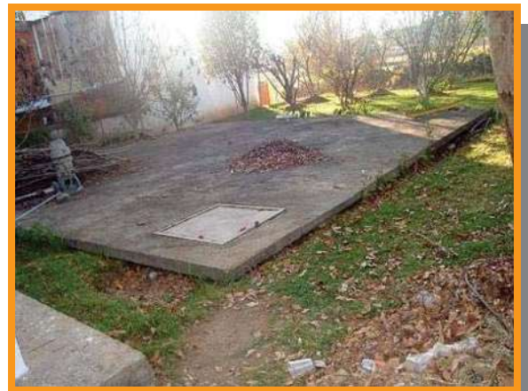
Tanque elevado y cisterna de almacenamiento para el rebombeo que suministra de agua a la colonia Infonavit 2. Edad de 13 años con capacidad de 60m 3
