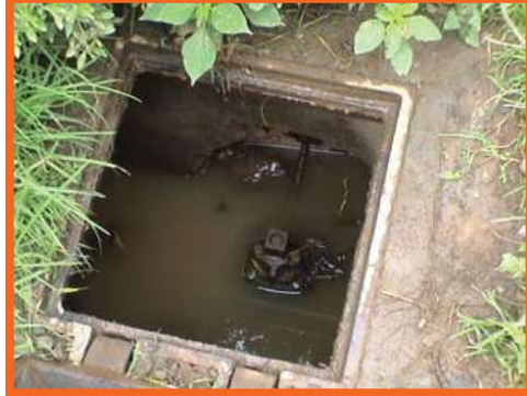
FUGA EN VÁLVULA DE SECCIONAMIENTO
