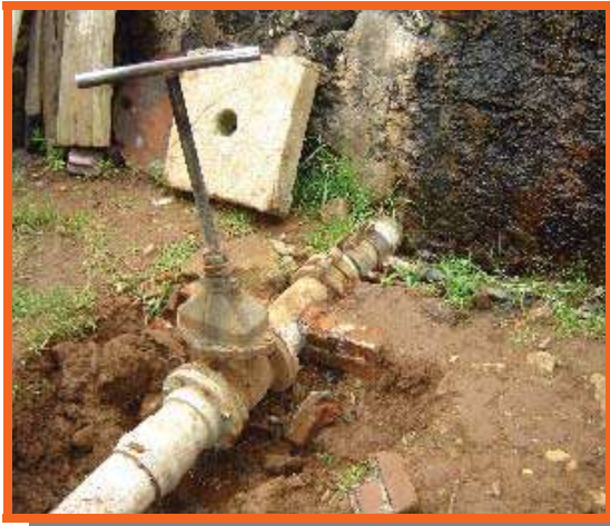
Válvula de seccionamiento de 6" del tanque de mayores dimensiones
