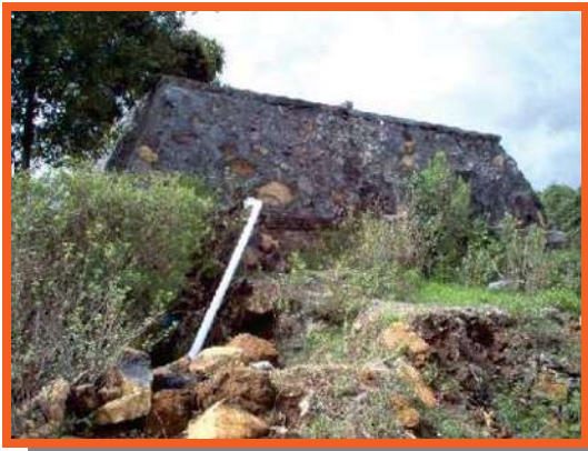
Tanque sin uso en la Colonia Eréndira III. Vista 1
