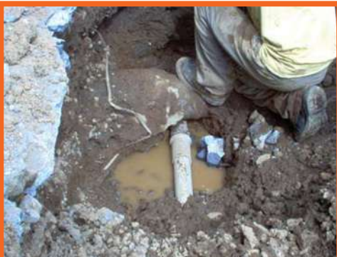
FUGA EN TUBERIA DE DISTRIBUCIÓN
