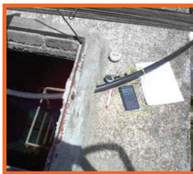
Trabajos de aforo del gasto de las fugas en los tanques de regularización del Calvario
