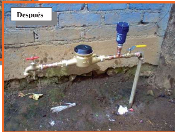
Vista de una toma domiciliaria actual y de las mas comunes en la zona del Distrito Hidrométrico.
