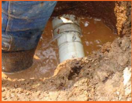
FUGA EN TAPON DE EXTREMO DE TUBERIA EN LA RED DE DISTRIBUCIÓN; CALLE SAN ANTONIO
