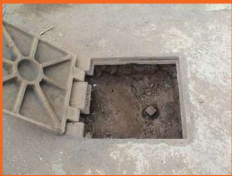
AZOLVE EN CAJAS DE VÁLVULAS; AV. JAMUQUEN
