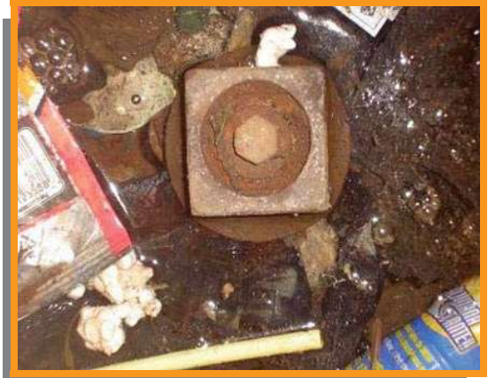
Válvula de seccionamiento con problema de fugas y azolve
