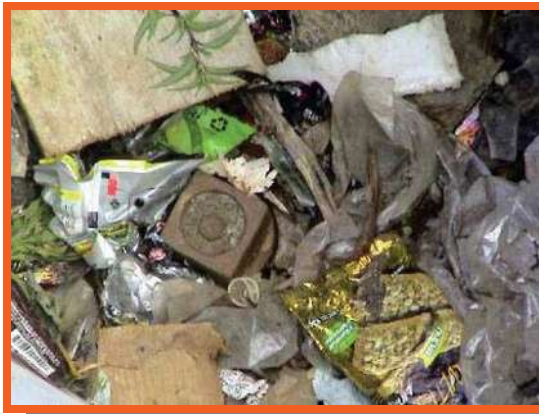
Válvula de seccionamiento azolvadas por falta de mantenimiento
