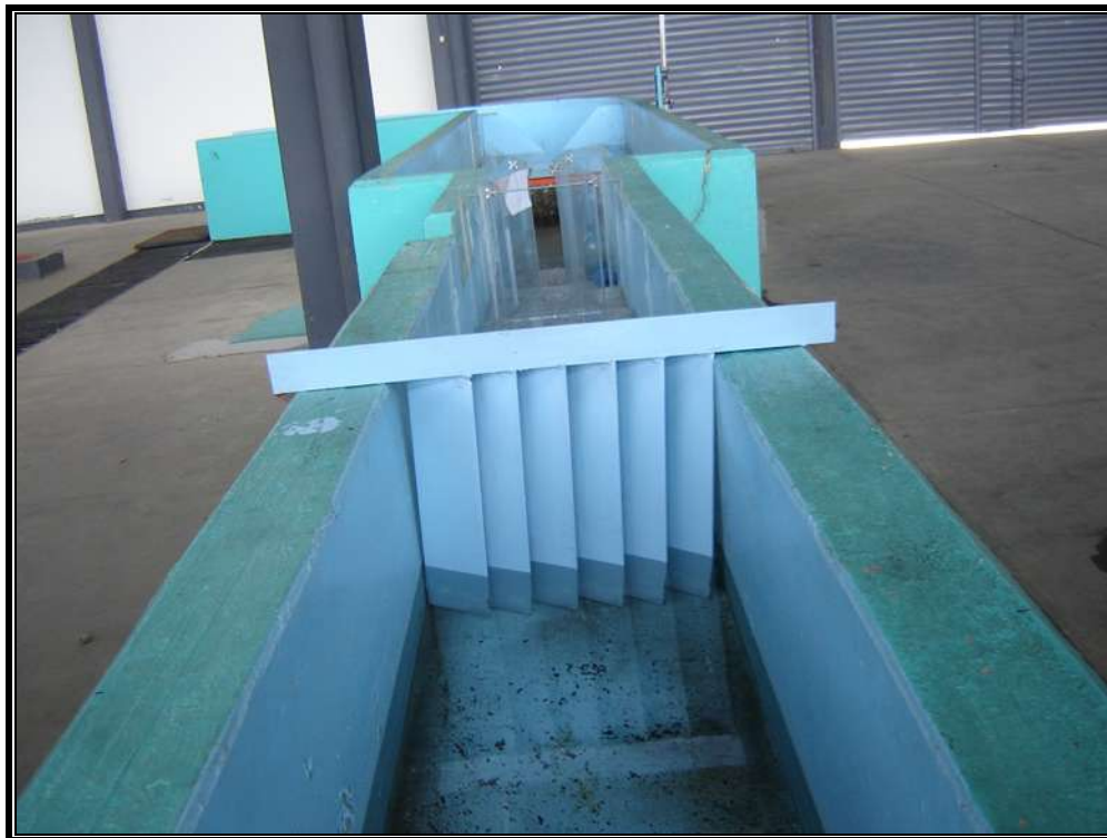
Figura 30. Rejilla ubicada aguas arriba del aforador Parshall
