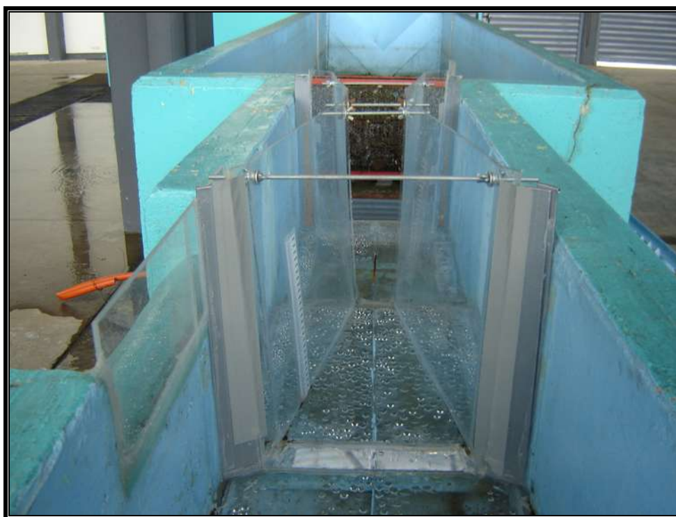
Figura 33. Paredes del aforador Parshall modificadas en su verticalidad
