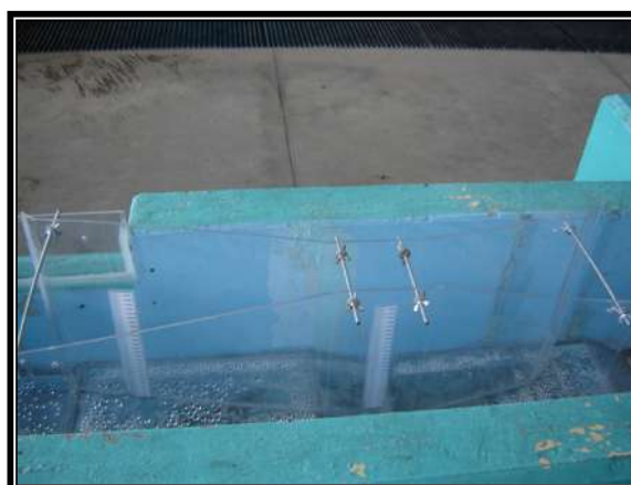
Figura 21. Escalas colocadas en el aforador
