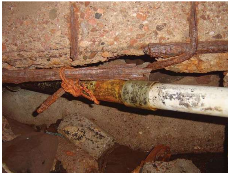
Figura II.2. Efecto de la corrosión del acero
