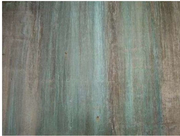
Fig. III.28 Representación de daños en PANTALLA INT. XIX_49-4-50-4, del Módulo XIX.
