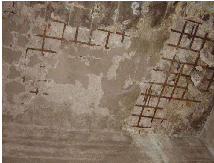
Fig. III.27 Representación de daños en LOSA V_5-42,-5-43,6-43,6-42, del Módulo V.
