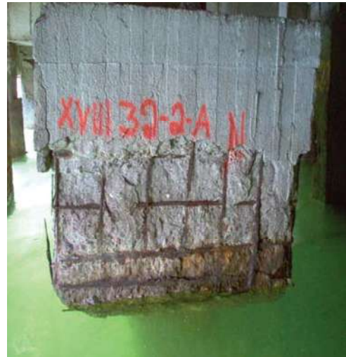
Fig. III.5 Representación de daño por desconchamiento con exposición de acero.
