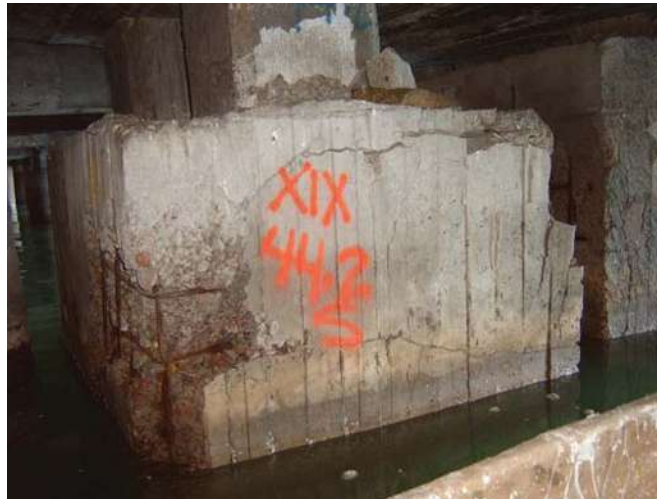
Fig. III.20 Representación de daños en los pilotes 44-2 y 45-2 del Módulo XIX.
