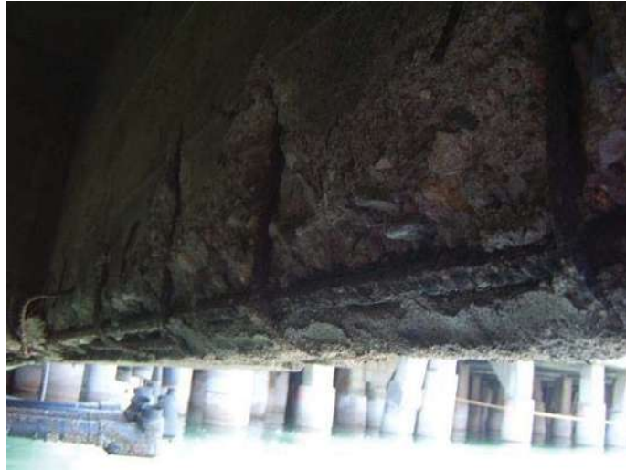
Fig. III.23 Representación de daños en TRABE XVII_23-26,21-26, del Módulo XVII.
