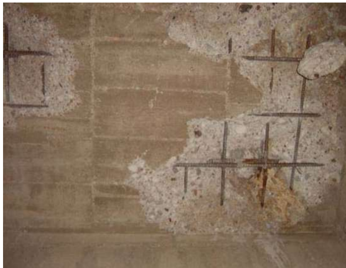
Fig. III.26 Representación de daños en LOSA IX _4-82B, 4-82,4-81,4-81A, del Módulo IX.
