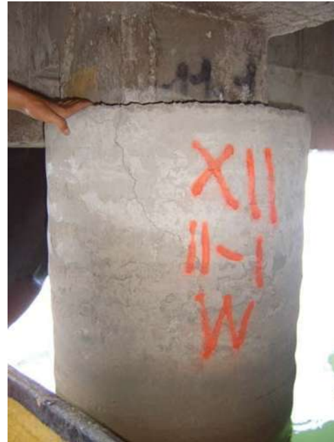
Fig. III.1 Representación de daño por delaminación
