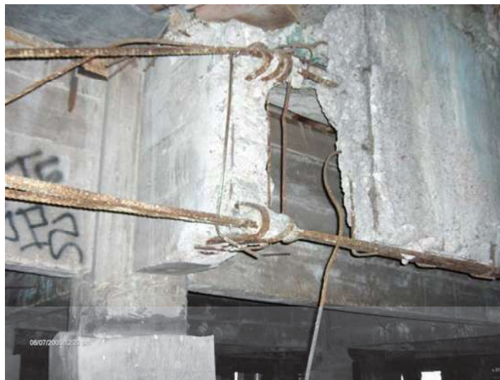
Fig. III.22 Representación de daños en TRABE II_9-19,10-19, del Módulo II.
