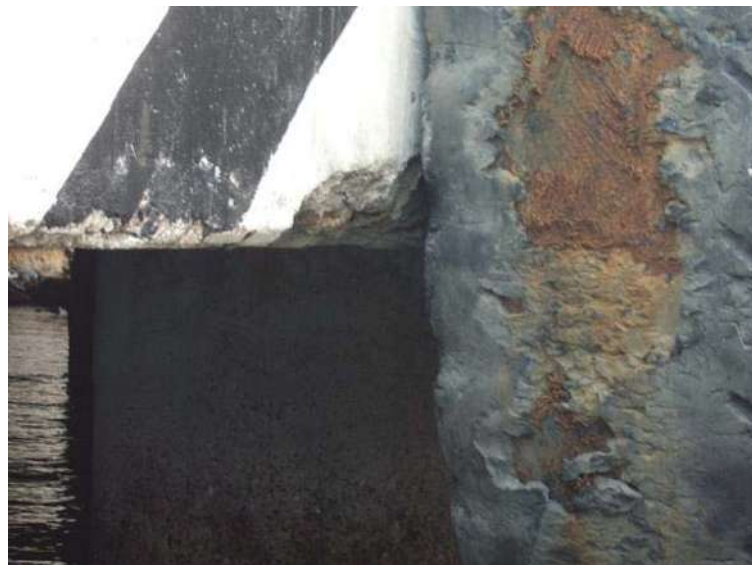
Fig. III.29 Representación de daños en PANTALLA EXT. XXIII_6,7, del Módulo XIX.
