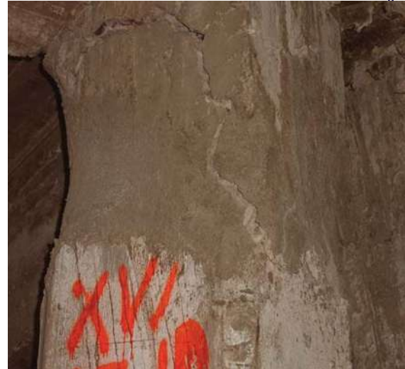
Fig. III.7 Representación de daño por fisuras.
