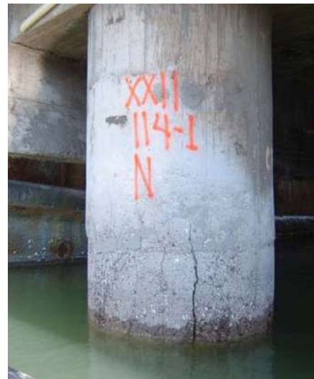
Fig. III.4 Representación de daño por desconchamiento.
