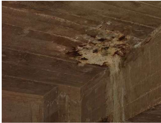
Fig. III.25 Representación de daños en LOSA IV_9-36,9'-36,9'-35,9-35, del Módulo IV.
