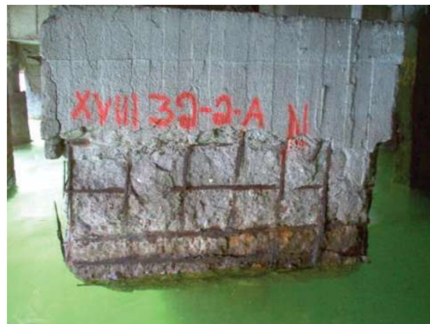
Fig. III.19 Representación de daños en los pilotes No. 32-2 y 32-2A, del Módulo XVIII.
