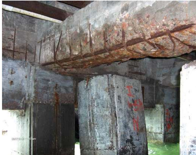
Fig. III.21 Representación de daños en TRABE I_1-5,2-5, del Módulo I.
