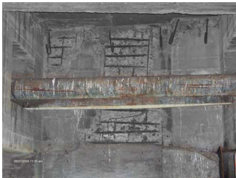
Fig. III.28 Representación de daños en PANTALLA INT I_1-8,1-9, del Módulo I.
