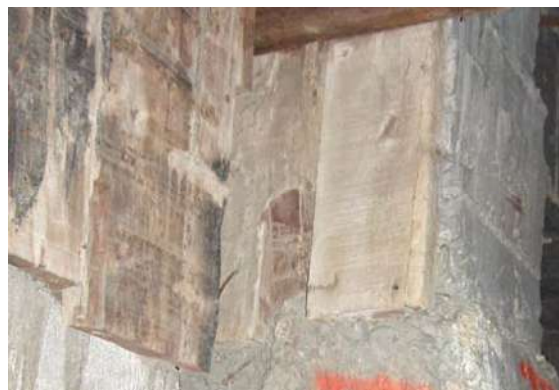
Fig. III.6 Representación de daño por incrustaciones de madera.
