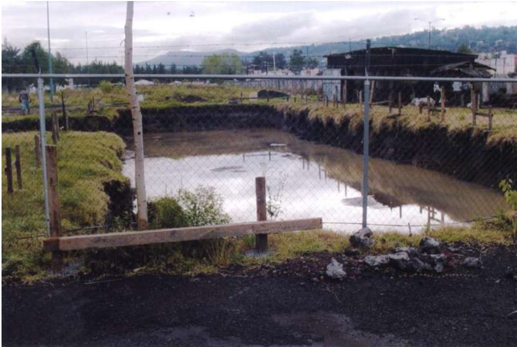
Inundación de la excavación
