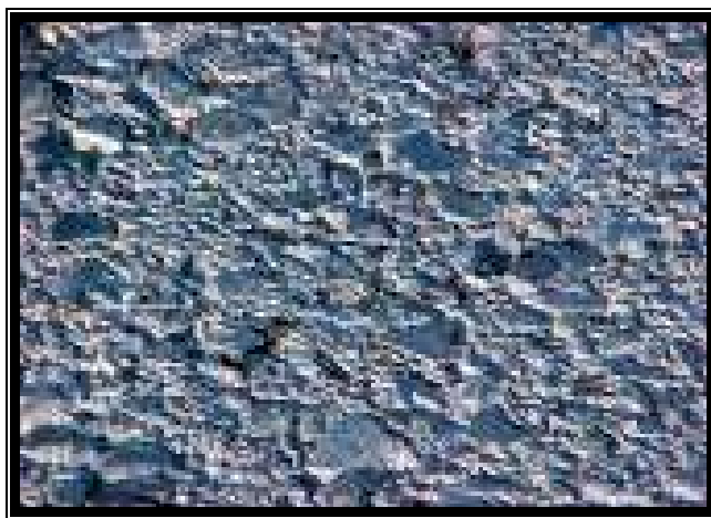
Fig 1.7 Desgaste de los agregados
