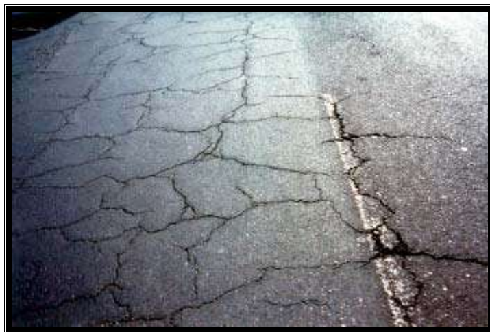
Fig 1.15 Fisuras solas o en retícula
