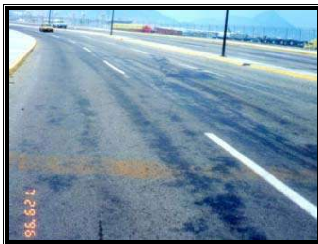
Fig 1.6 Exudación de asfalto
