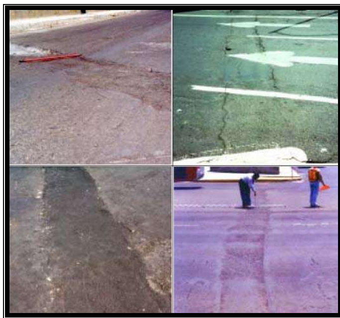
Fig 1.17 Defectos en la construcción
