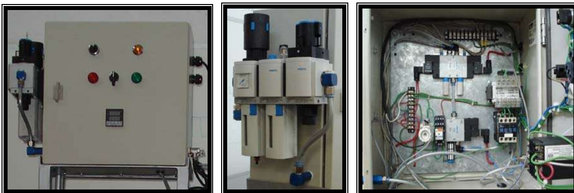
Fig. 3.11 Unidad control y mantenimiento
