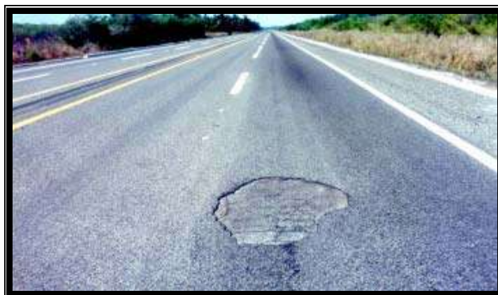
Fig 1.4 Pérdida de capa de rodadura
