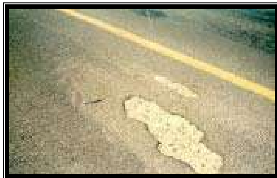
Fig 1.3 Pérdida de agregados
