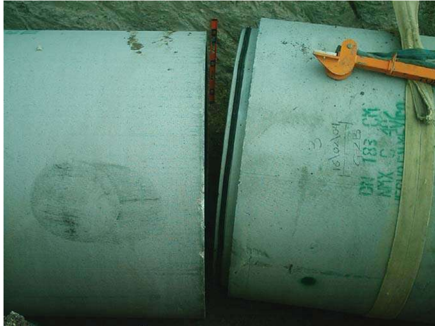
COLOCACION DE JUNTA DE HULE EN ESPIGA DEL TUBO LISTA PARA SER INSTALADA
