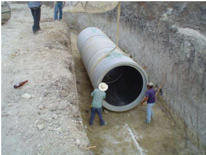
INSTALACION DE TUBERIA DE LA PARTE MAS BAJA HCIA LA PARTE MAS ALTA
