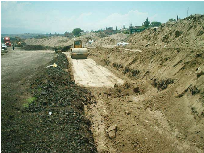
RELLENO DE MATERIAL PRODUCTO DE LA EXCAVACION EN CAPAS DE 50 CM. CON COMPACTADOR VIBRATORIO
