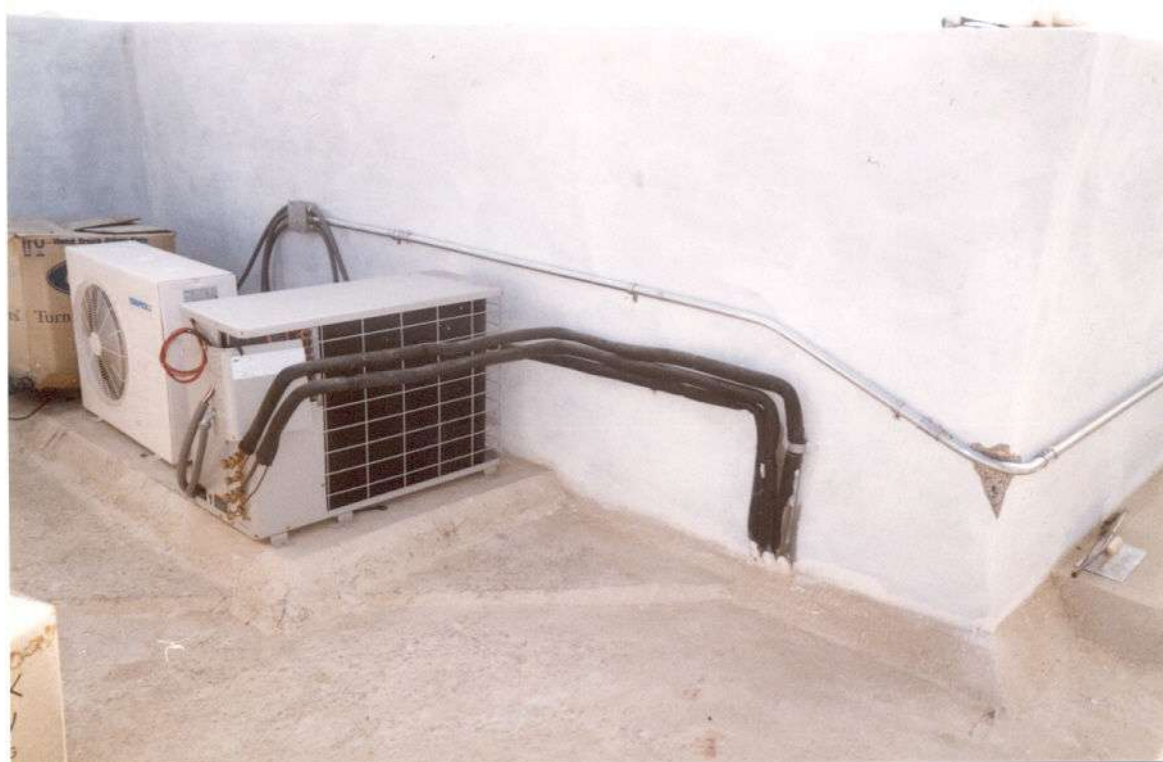
Aire acondicionado (mini split)
