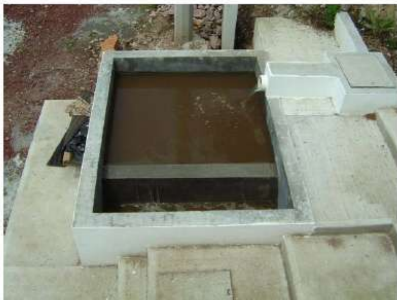
DESCRIPCION: LLEGADA DE AGUA A SEDIMENTADOR.
