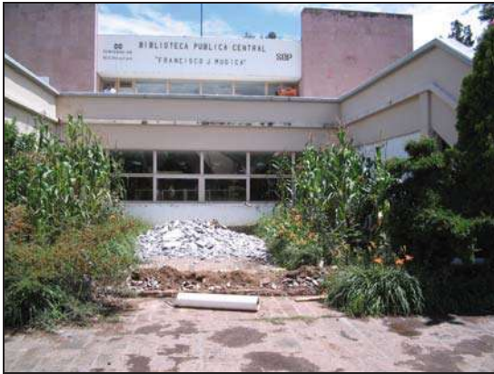
Foto IMTA 2004. Entrada a la Biblioteca Francisco J. Mújica. Se observa el recurrente deterioro de las aguas pluviales encharcadas que alcanzan hasta 50 centímetros de altura.
