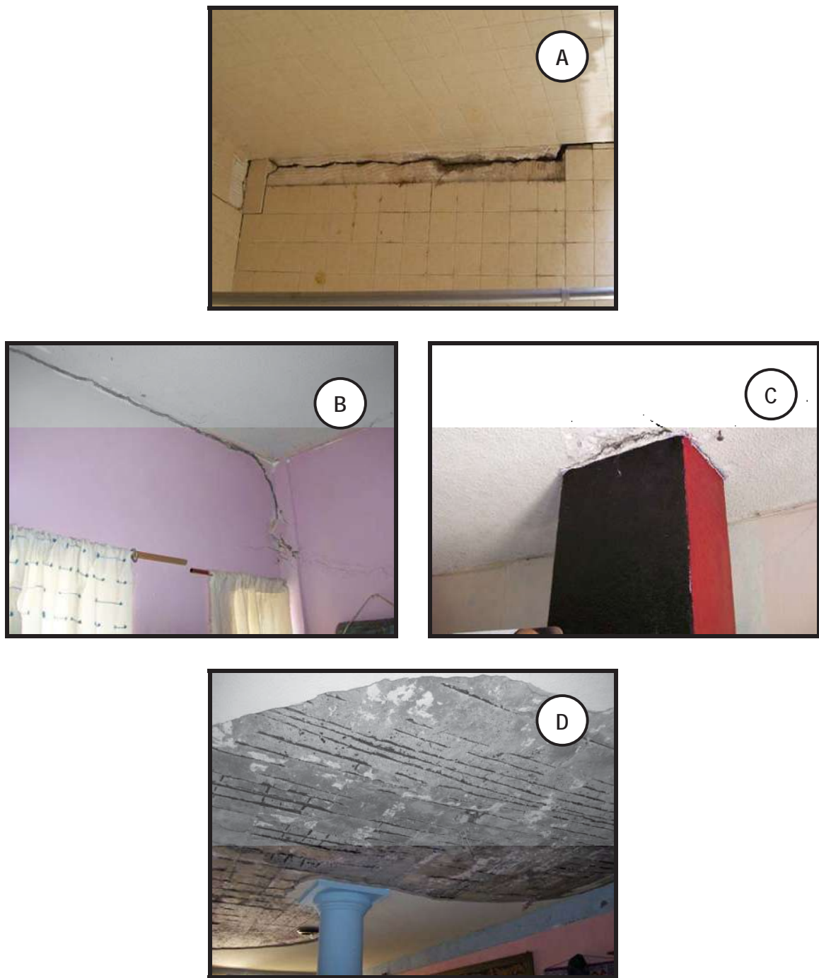
Figura 4.16 Daños sobre la falla Chapultepec (H. Colegio militar No. 129).
