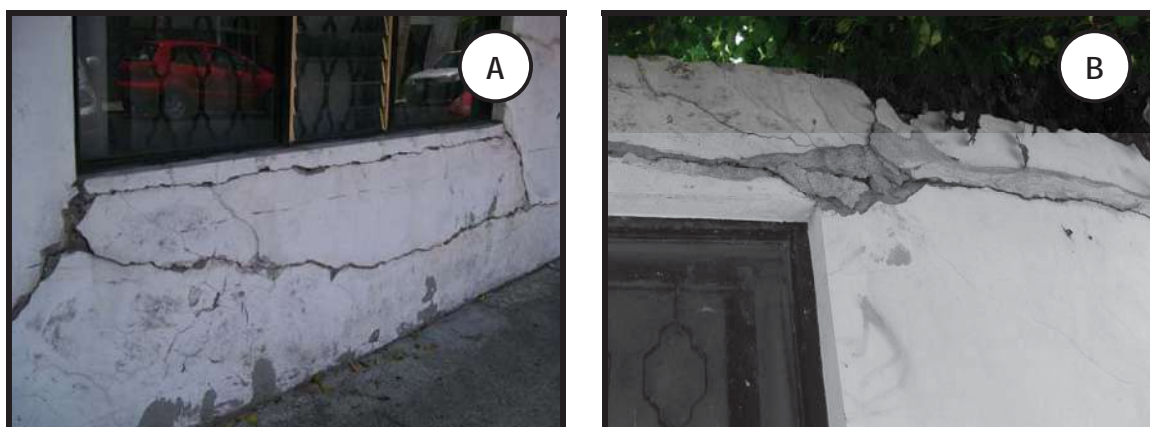
Figura 4.17 Daños sobre la falla Chapultepec (8 de Septiembre No.129).
