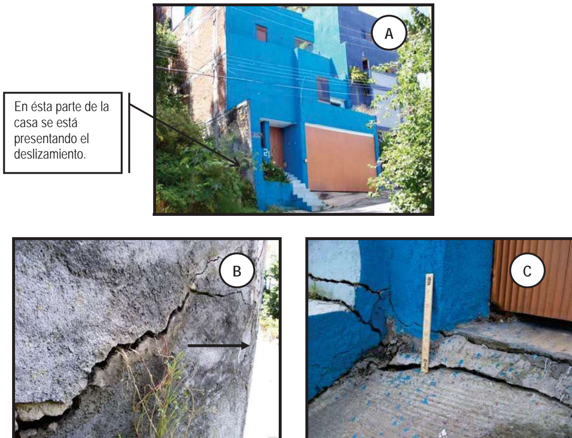
Figura 4.26 Daños ocasionados por la falla de La Paloma (J. Strauss No. 21)
