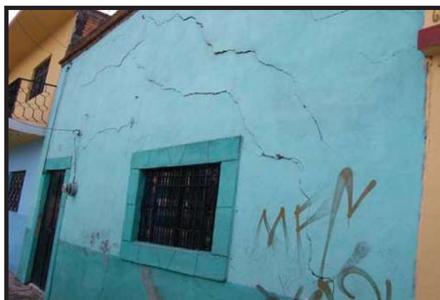
Figura 4.4 Daños sobre la falla de la Central Camionera (Arnulfo Ávila No. 530).
