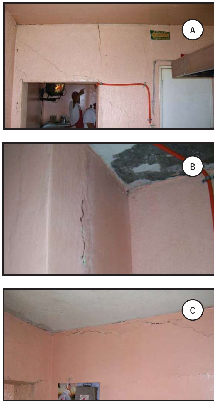
Figura 4.13 Daños sobre la falla de Cuautla (Cuautla No. 903 C).
