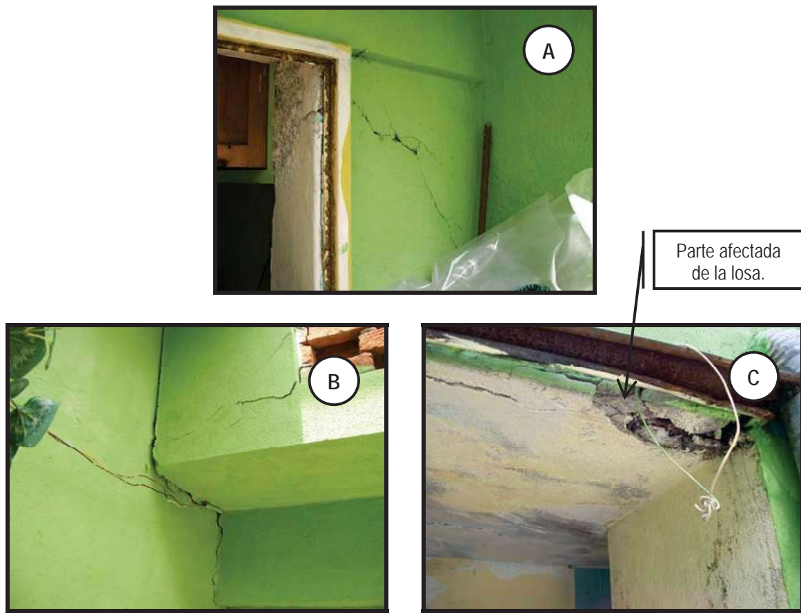
Figura 4.12 Daños sobre la falla de Cuautla (Durango No. 160).
