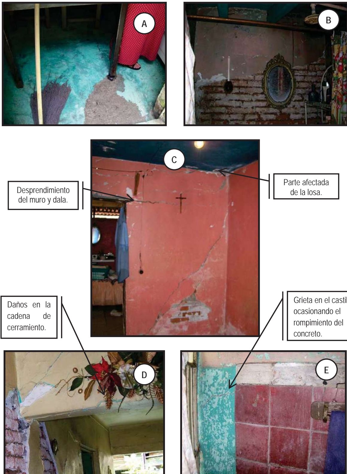
Figura 4.11 Daños sobre la falla de Cuautla (Jacona No. 348).
