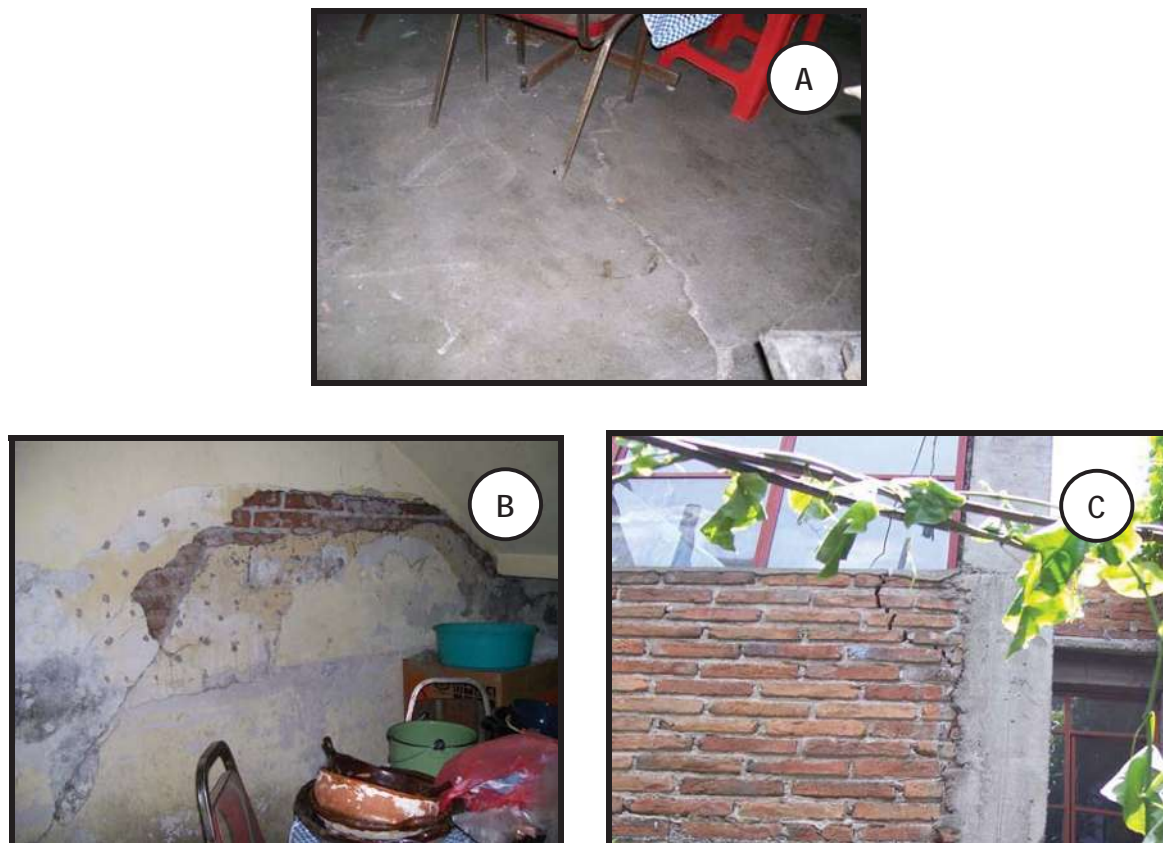
Figura 4.3 Daños sobre la falla de la Central Camionera (Juan Álvarez No. 158).
