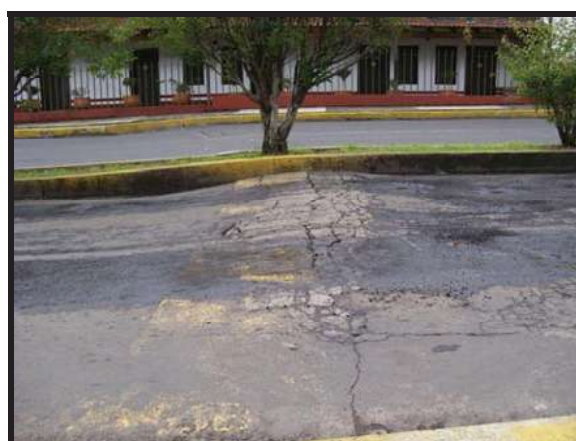
Figura 4.10 Daño en infraestructura sobre la falla de Torremolinos: Avenida Periodismo, frente al Hotel Torremolinos.
