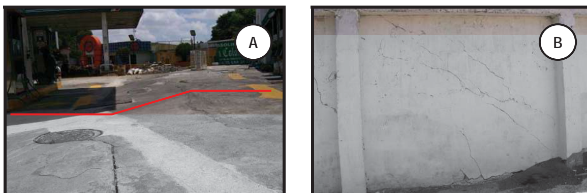
Figura 4.6 Daños sobre la falla de la Central Camionera (Gasolinera “La Colonial”).
