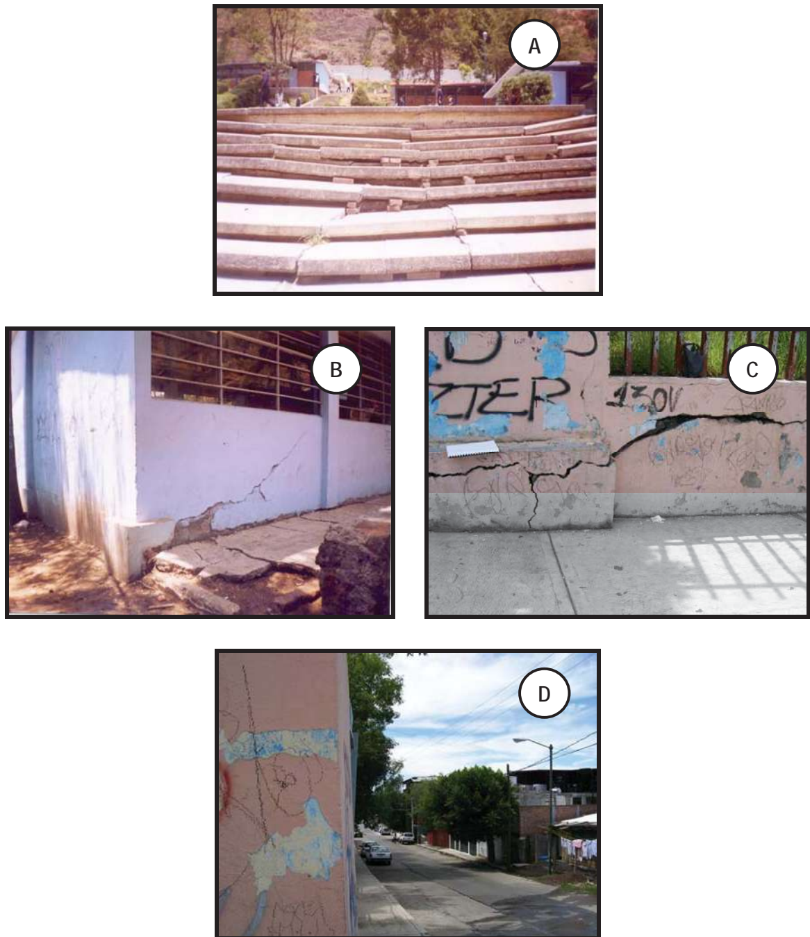
Figura 4.25 Daños ocasionados por la falla de La Paloma (Secundaria Técnica No. 77).
