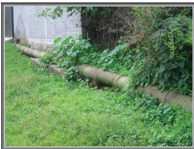
Fotografía No. 4.3 Tubería de 20cm (8") de diámetro. En la calle Aquiles Serdán.
