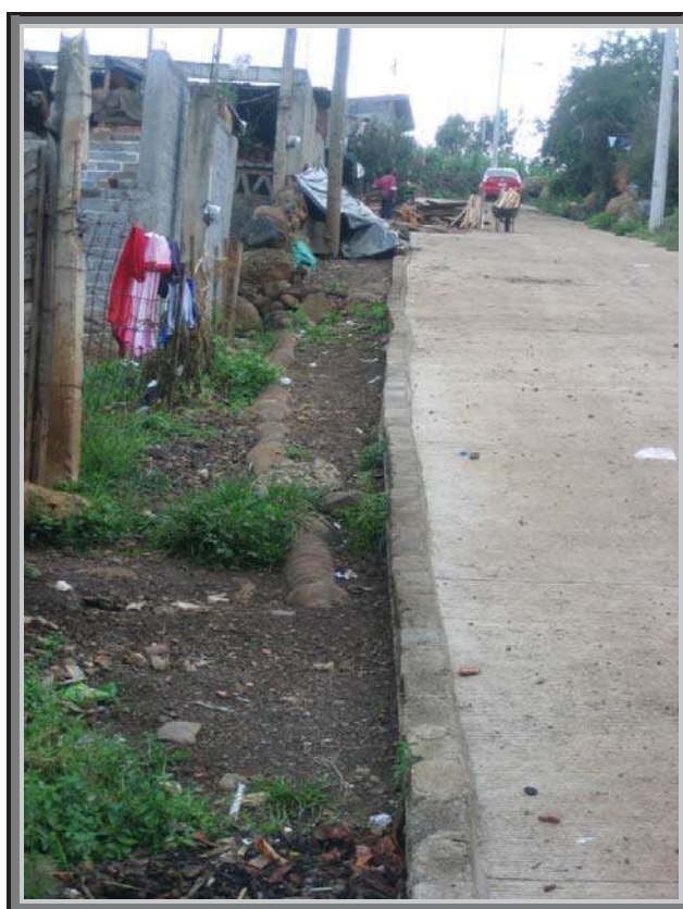
Fotografía No. 4.4 Tubería de 20cm (8") diámetro. Calle Fray de Basalenque
