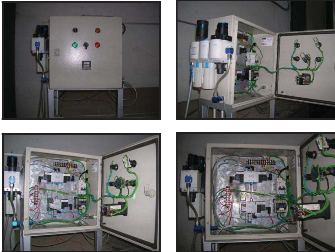
Fig. 6.2 Unidad de control y mantenimiento
