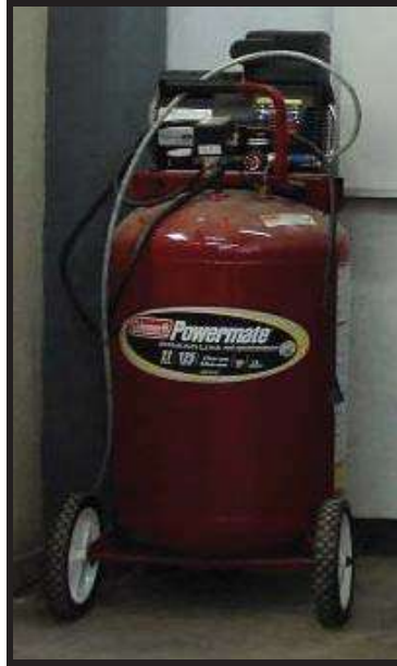
Fig. 6.1 Compresor de aire.
