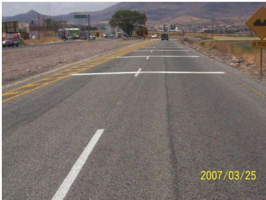
COLOCACION DE PINTURA Y SEÑALAMIENTO EN LA GLORITA AL ACCESO A LA CARRETERA # 90
