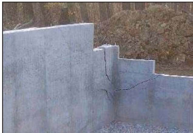
Figura 16 Aparición de grieta en el concreto con poco tiempo de fraguado
