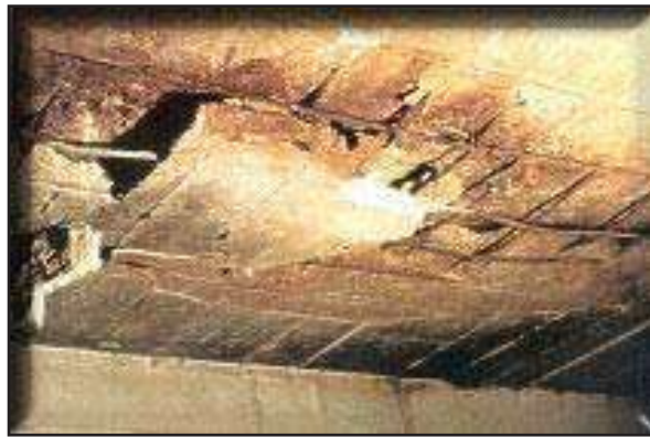
Figura 27. Daño por fuego producido en estructura de concreto armado Obtenido en www.bomberojez.com/accesor/descar/patologia48.pdf -
