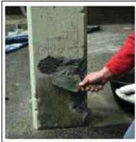
Figura 48. Una vez saneadas las armaduras se protegerán con resinas tipo SIKATOP 100 epoxi obtenido en www.es.wikibooks.org/wiki/Patologia de la edificación
