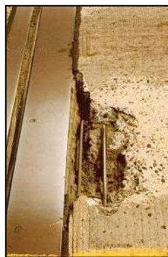
Figura 11 Erosión en el concreto expuesto al tráfico vehicular
