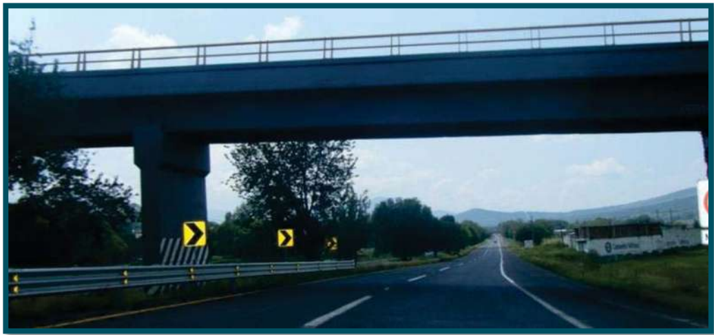
Fig. 4.10 Puente vehicular característico en el estado, sometido a carga viva vehicular. Carretera Morelia – Pazcuaro.
