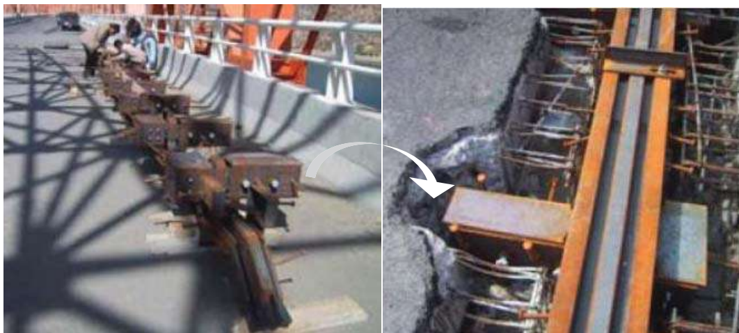
Figura. 2.14 Juntas de dilatación instaladas en la calzada.
