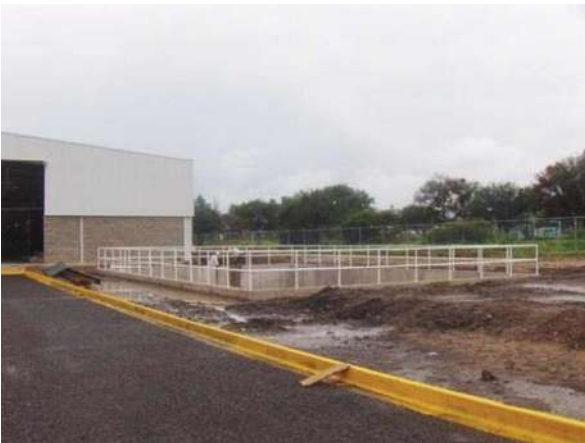
FOTOGRAFÍA No. 48. Cárcamo de lixiviados.
