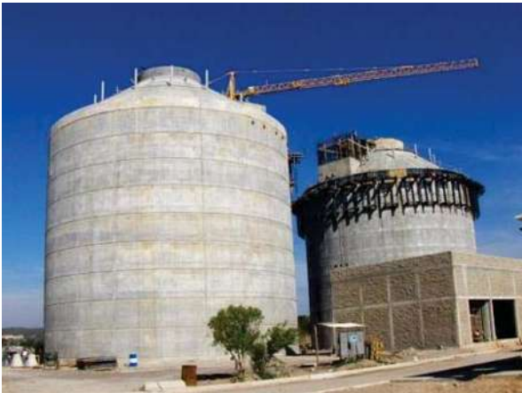
FOTOGRAFÍA No. 56. Tanque digestor anaerobios No.1.
