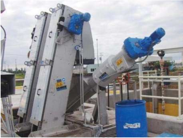
FOTOGRAFÍA No. 2. Rejillas mecánicas
