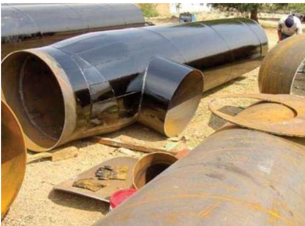
FOTOGRAFÍA No. 101. Tubería con recubrimiento.
