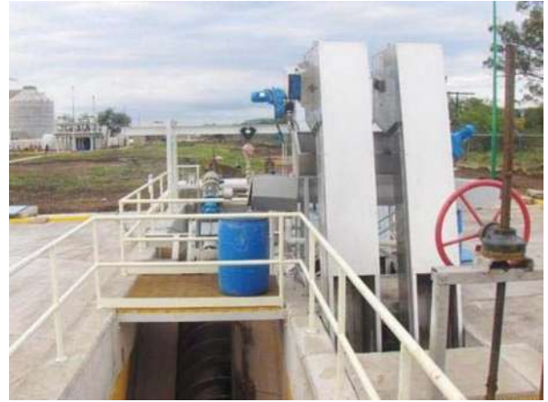
FOTOGRAFÍA No. 3. Tornillo de Arquímedes.
