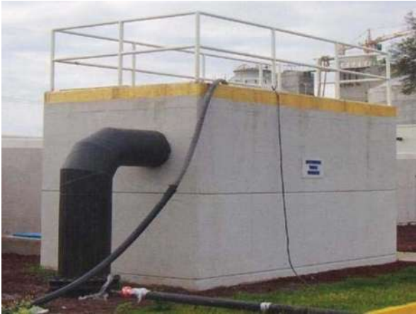
FOTOGRAFÍA No. 6. Tanque de distribución.
