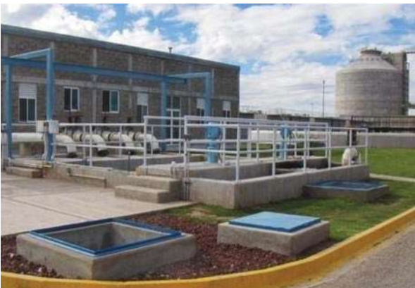
FOTOGRAFÍA No. 46. Tanque de medición de PH.
