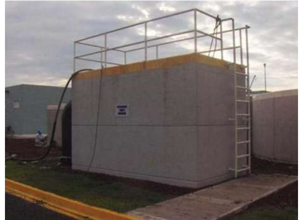
FOTOGRAFÍA No. 7. Tanque de distribución vista lateral.
