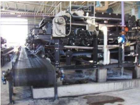
FOTOGRAFÍA No.19. Filtros banda
