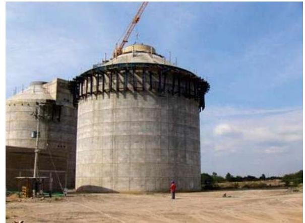
FOTOGRAFÍA No. 57. Tanque digestor anaerobios No.2.
