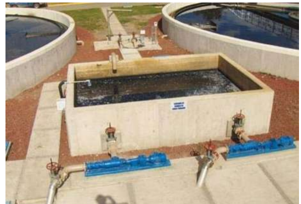
FOTOGRAFÍA No. 47. Cárcamo de bombeo.
