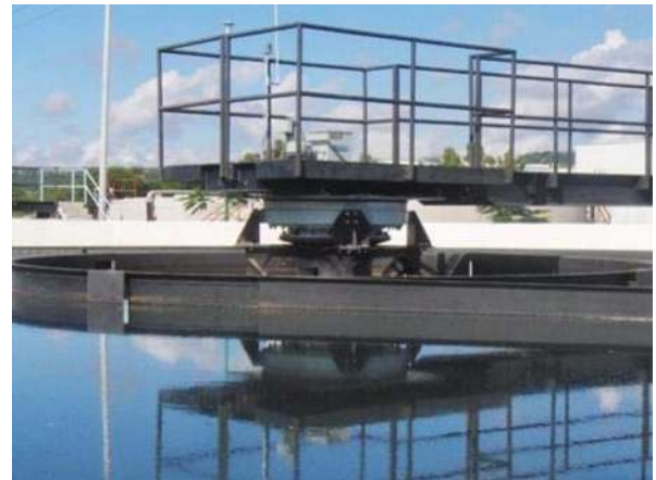
FOTOGRAFÍA No. 13. Co-espesador. Mampara
