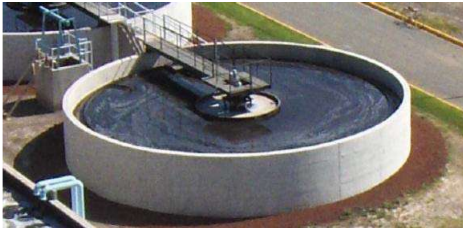
FOTOGRAFÍA No. 16. Sedimentador secundario.
