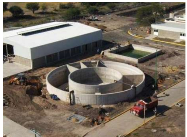
FOTOGRAFÍA No. 49. Tanque de almacenamiento de lodos.
