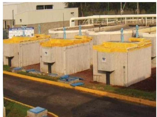
FOTOGRAFÍA No.11. Tanque mezclador, vista panorámica.
