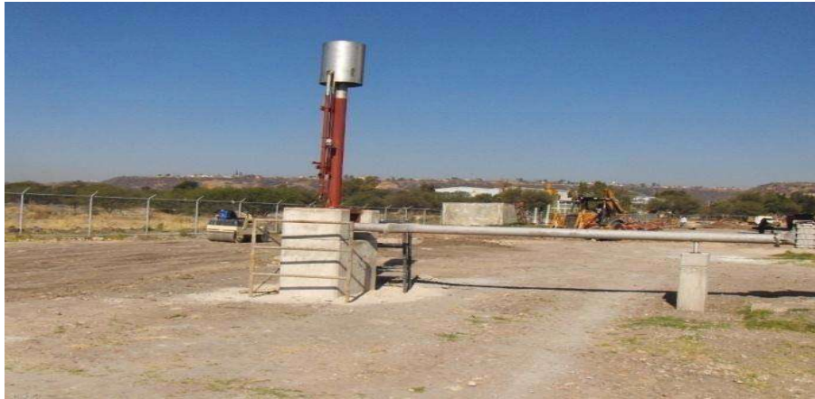
FOTOGRAFÍA No. 21. Quemador de biogás
