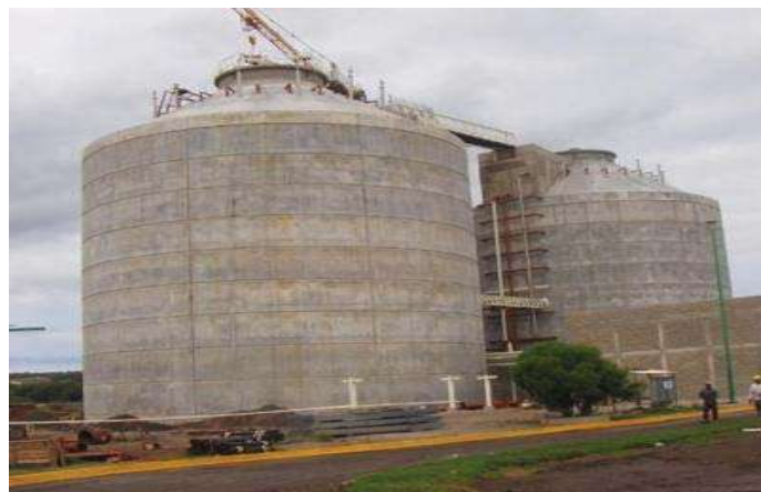
FOTOGRAFÍA 18.0. Digestores anaerobios de lodos.
