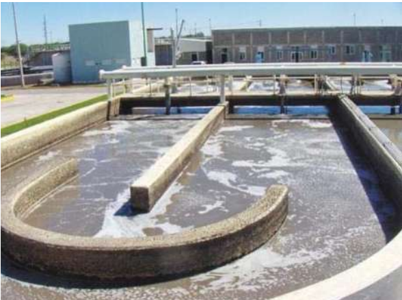
FOTOGRAFÍA No. 8. Tanque de homogenización.
