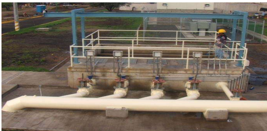
FOTOGRAFÍA No. 17. Cárcamo de bombeo de agua tratada.
