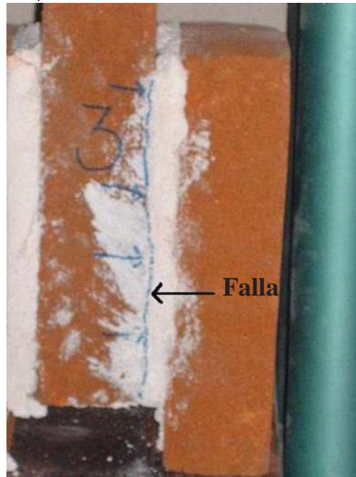
Figura 7.19. Tipo de Falla 1
