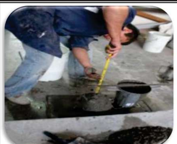
Fig. 4.3.2.4. Se mide el revenimiento que de proyecto es 10 cm. con una tolerancia de \pm 3.5 cm para verificar la calidad de la mezcla.
