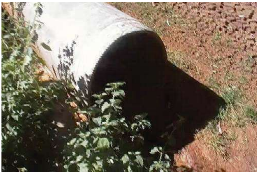
FOTOGRAFIA 23. Tubería de descarga de lodos a la loma de Santa María.
