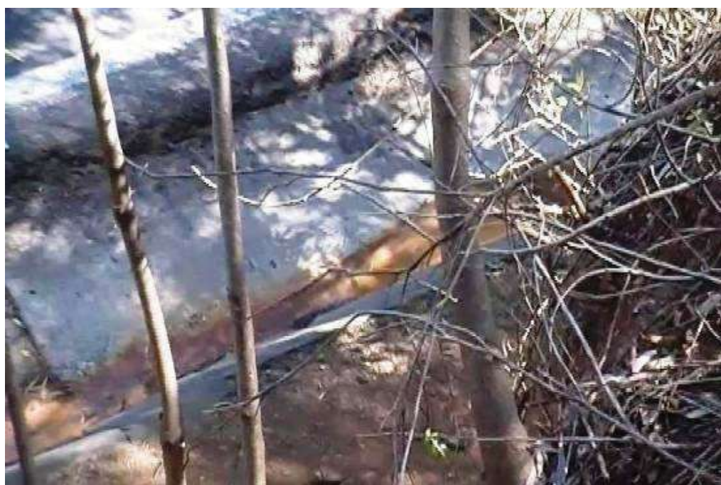
FOTOGRAFIA 25. Lodos escurriendo por la cuneta del camino a Santa María. (JNHA).
