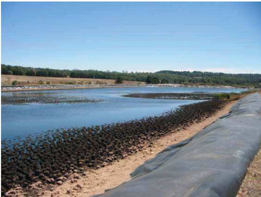
FOTOGRAFIA 8. Una de las tarquinas de lodos de la potabilizadora de Los Berros (JNHA).
