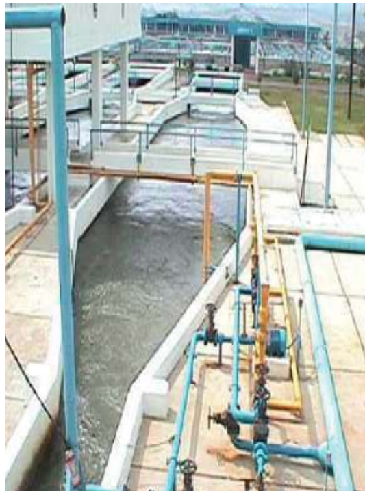
FOTOGRAFIA 3. Canales Parshall de la planta potabilizadora Los Berros (CNA-2007).
