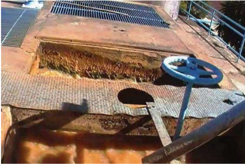
FOTOGRAFIA 20. Caja de premezclado de la Potabilizadora de Santa María. Morelia Mich. (JNHA).
