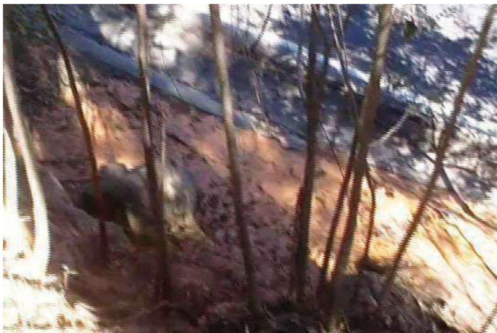
FOTOGRAFIA 24. Lodos Cayendo por la loma de Santa María a la cuneta del calle que baja hasta la Avenida Camelinas. (JNHA).
