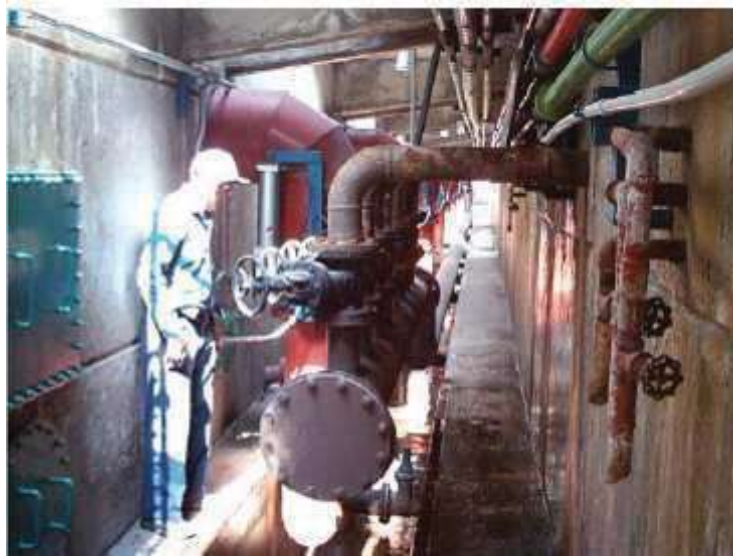
FOTOGRAFIA 14. Purga del manto de lodos de los Pulsators, potabilizadora el Florido. Tijuana, BCN. (SEYCO).
