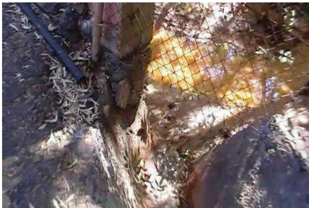
FOTOGRAFIA 26. Entrada de los lodos de la cuneta al arroyo que se encuentra dentro del Hotel Real Camelinas. (JNHA).
