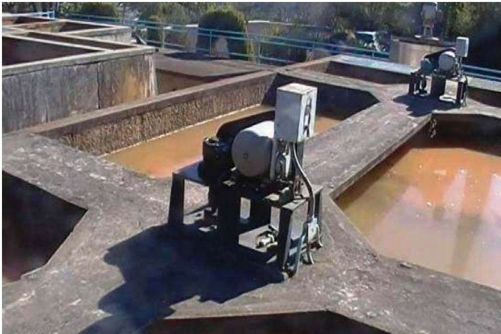
FOTOGRAFIA 21. Tanques de mezclado de la Potabilizadora de Santa María. Morelia Mich. (JNHA)
