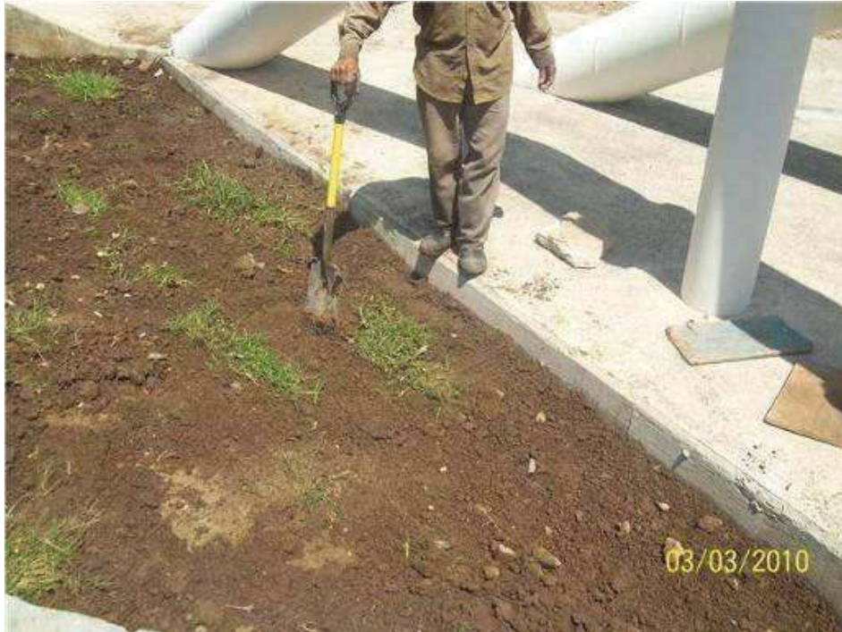
FOTOGRAFIA 10. Disposición de lodos en la planta potabilizadora Ciudad del Agua Juan Sabines Gutiérrez. Chiapa de Corzo, Chiapas).
