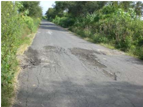
DAÑOS DEL CAMINO INDAPARAPEO- LAS BOMBAS. KM 0+000 AL 6+480. MUNICIPIO INDAPARAPEO, MICH.
