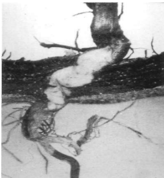
Figura 5.20. Perforación producida por raíces de cardos en una membrana asfáltica (Minke, 2004).
