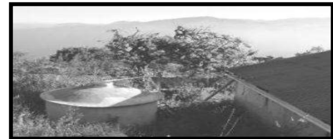
IMAGEN 3.15. TANQUE CILÍNDRICO DE FERROCEMENTO.
