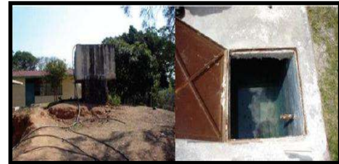
IMAGEN 3.9. TANQUE DE TABIQUE – CEMENTO.
