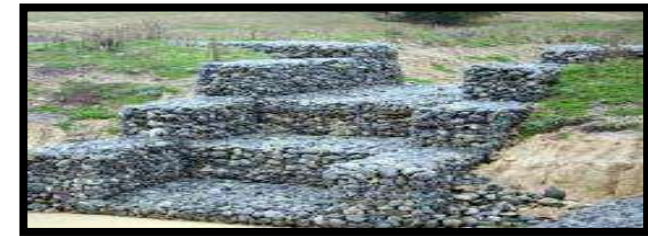
IMAGEN 2.8. DIQUE CON GAVIONES.
