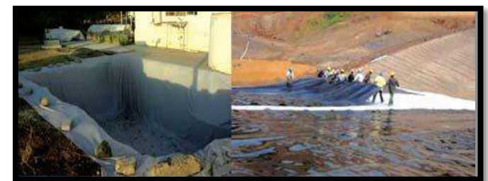
IMAGEN 3.10. CISTERNAS REVESTIDAS CON GEOMEMBRANA DE PVC
