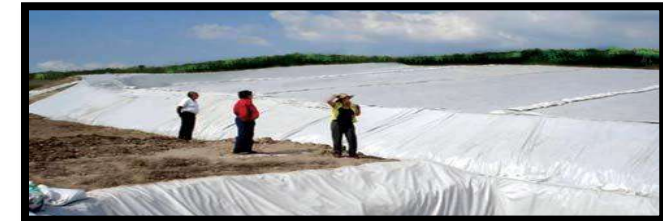
IMAGEN 3.4. LADERA RECUBIERTA CON GEOMEMBRANA DE PVC ACONDICIONADA COMO ÁREA PARA CAPTACIÓN DE AGUA DE LLUVIA
