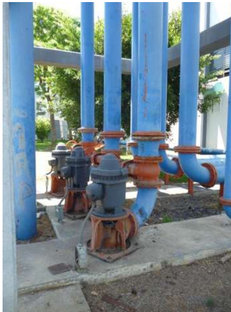
Figura 5.12. Bombas que alimentan el tanque elevado.
