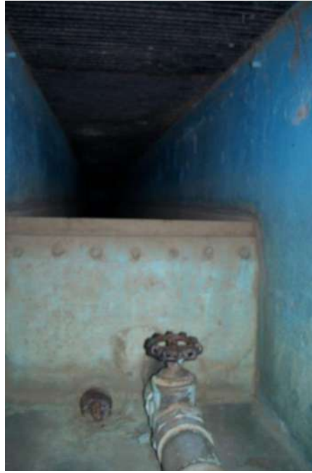
Figura 3.10 Válvula para desfogue del canal.
