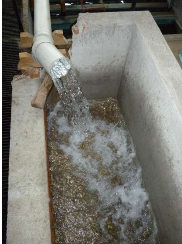
Figura 6.8. Tanque amortiguador al final de la tubería de 8".
