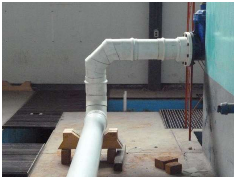
Figura 6.7. Fotografía de las conexiones que se colocaron después de la válvula de control.
