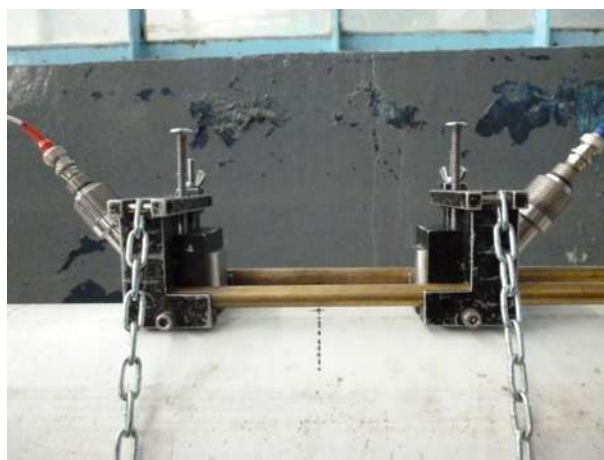
Figura 3.2 Transductores o sensores del medidor ultrasónico y riel, montados en la tubería.
